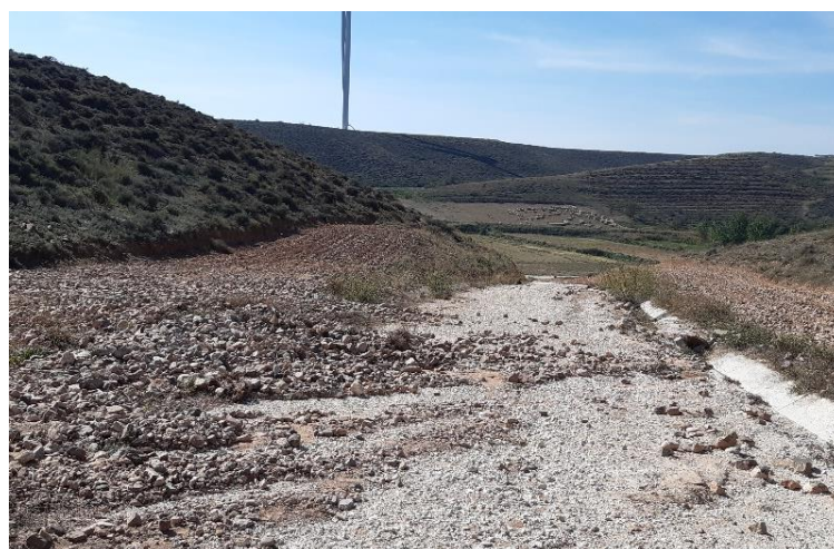
Foto 2. Vial obstruido por rocas en vial de acceso al aero L6D.04. Peligro al transitar.
