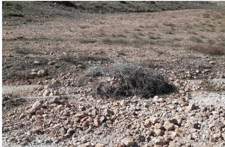
Foto 1. Cuneta llena de piedras y vegetación arbustiva en vial de acceso al aero L6D.04.
