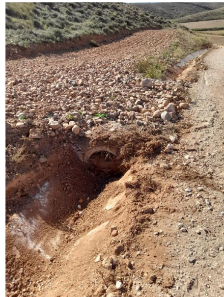
Foto 4. Limpieza de cunetas en mal estado.
