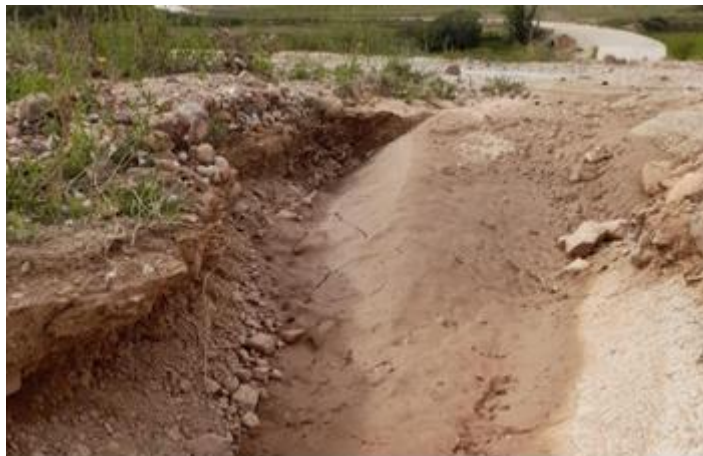
Foto 6. Erosión hídrica en materiales lutíticos del margen del vial de acceso a L6D.03.
