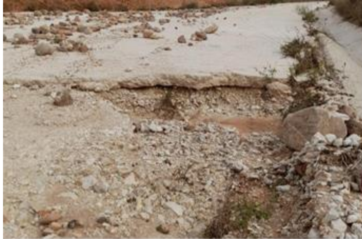
Foto 5. Erosión hídrica en materiales lutíticos del vial de acceso a L6D-04.
