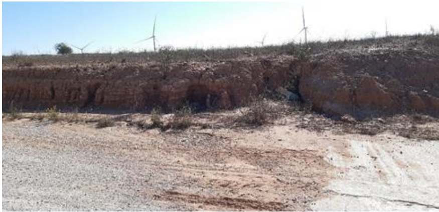
Foto 4. Erosión hídrica en materiales lutíticos del talud de desmonte del vial de acceso a LM6B – 09.
