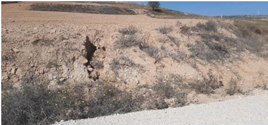
Foto 5. Erosión hídrica en materiales arenosos del talud de desmonte del vial de acceso a LM6B – 04.
