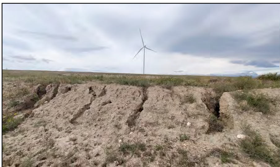
Fotografía 6. Regueros próximos a la turbina HE03 (18/09/2023).
