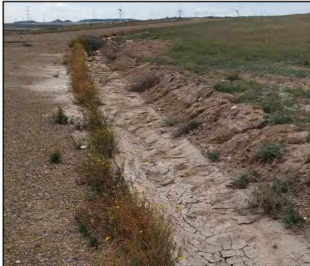
Fotografía 7. Cierta colmatación por sedimentos de las cunetas.
