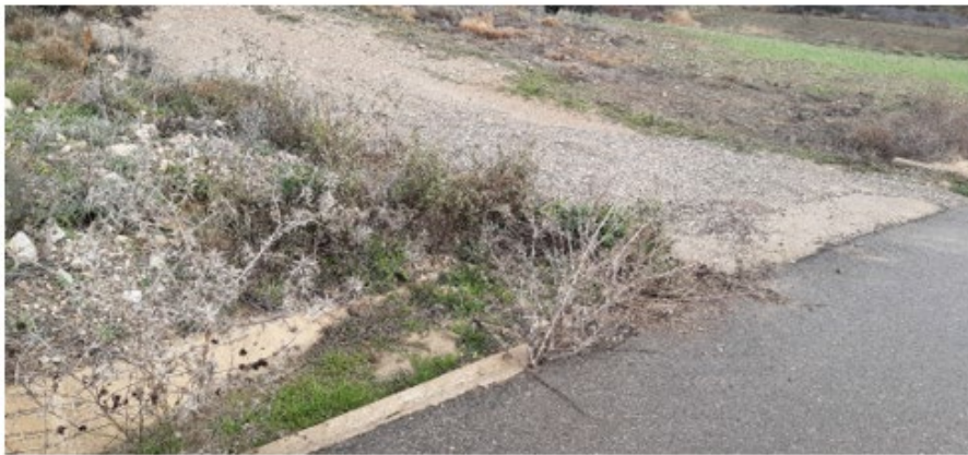
Cuneta llena de sedimentos y vegetación arbustiva en vial de acceso al aero LSA.08.
