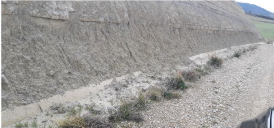
Cuneta llena de sedimentos en vial de acceso al aero LSA.02.
