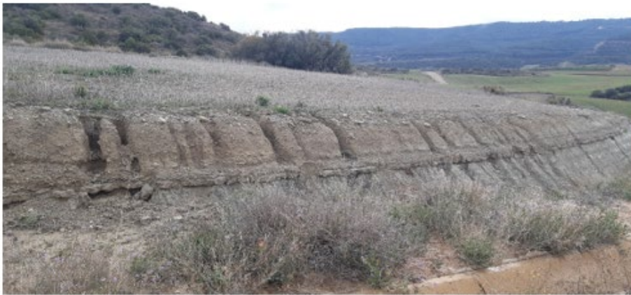
Erosión hídrica en materiales margosos del talud de desmonte del vial de acceso al aero LSA.07.
