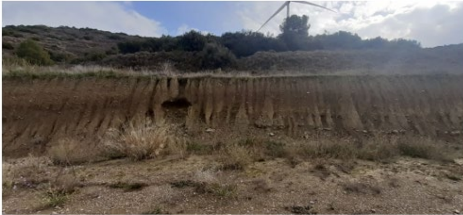
Erosión hídrica en materiales margosos del talud de desmonte del vial de acceso al aero LSA.02. Extensible a todo el vial
