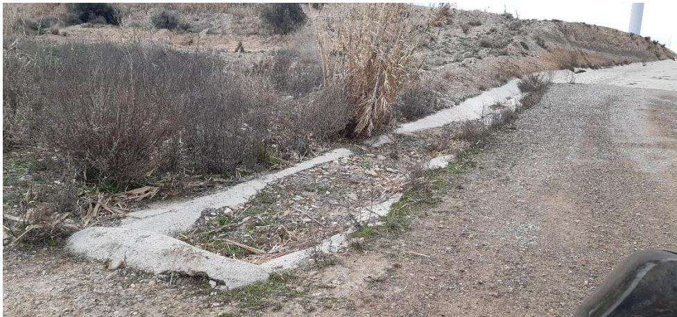
Fig. 1 Cuneta llena de sedimentos en vial de acceso al aero MU2.13
