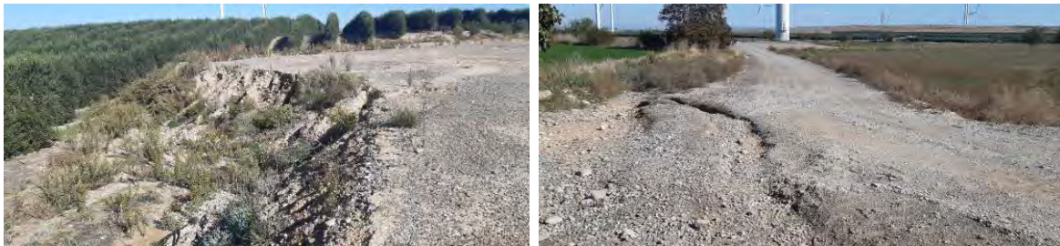
Fig. 1 Erosión hídrica del talud terraplén de plataforma MU2.09 Fig. 2 Erosión hídrica del vial de acceso a MU2.12
