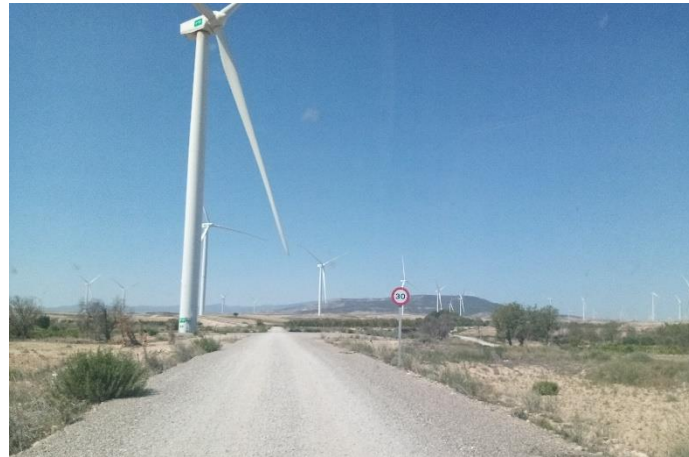
Fotografías 11 a 14: Estado de caminos y viales
