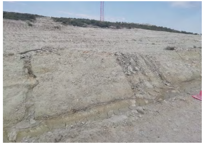
Figura 2: Erosión en talud.
