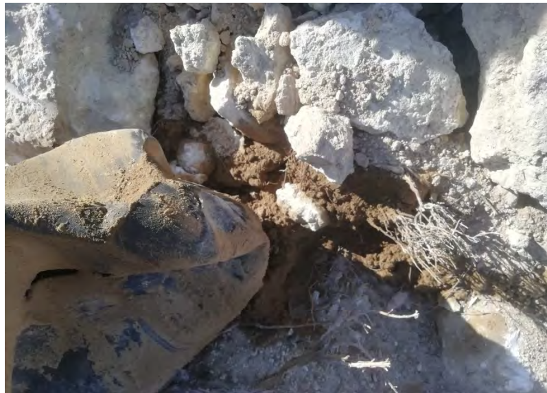
Figura 1: Mancha de líquido contaminante en la escollera al lado de la SET.
