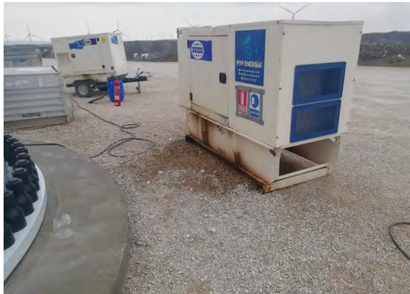
Figura 1: Mancha de líquido contaminante en plataforma de COT-03.
