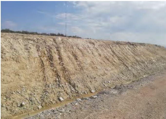
Figura 1: Erosión en talud.
