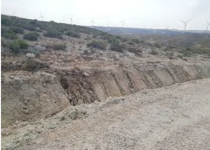
Figura 5: Erosión en cuneta.
