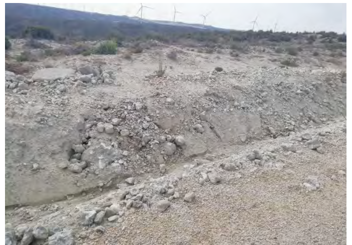
Figura 4: Erosión en cuneta.
