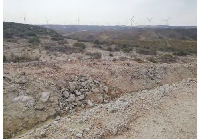
Figura 6: Erosión en cuneta.
