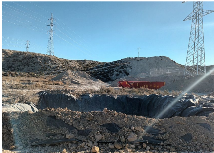
Figura 2: Balsa nueva de limpieza de cubas vacía
