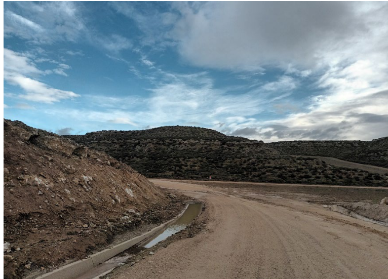
Figura 3: Cunetas eje 02-12 punto bajo tras lluvia
