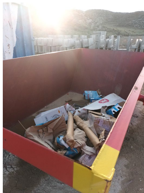
Figura 2: Punto limpio de RNP en la zona de la SET Campillo.
