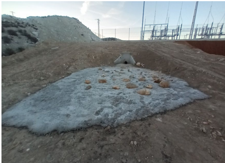
Figura 1: ODT de descarga y sistema de frenado de agua SET CAMPILLO
