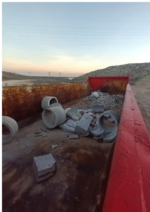
Figura 2: Restos de hormigón y ODTs de hormigón
