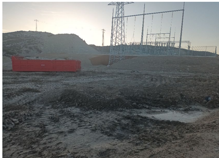
Figura 1: Balsa de limpieza SET CAMPILLO restituida
