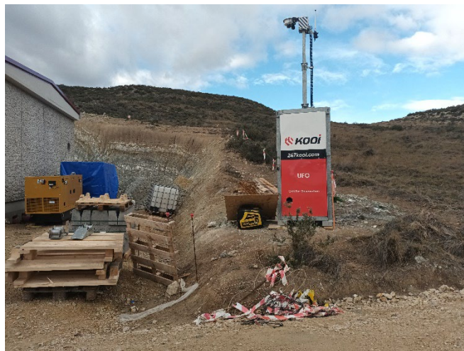
Figura 2: Falta de orden y limpieza en CS
