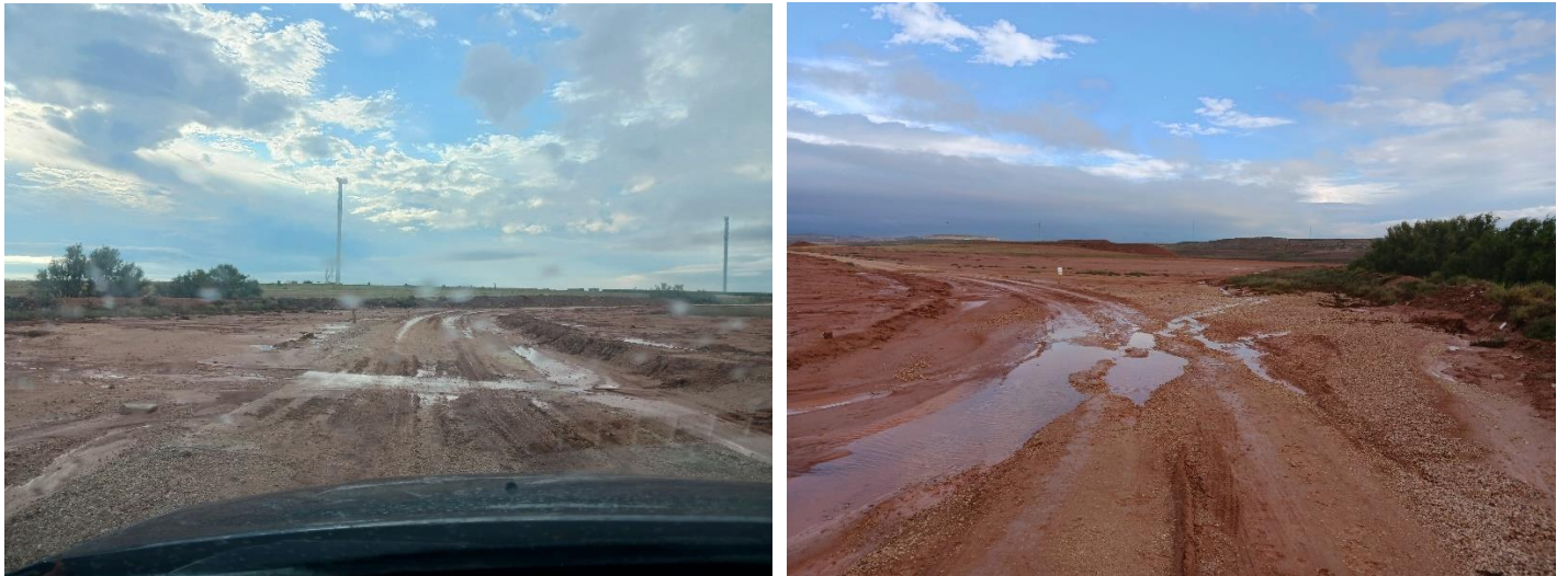
Figura 1 y 2: Cárcavas formadas en el vial de acceso tras las lluvias.
