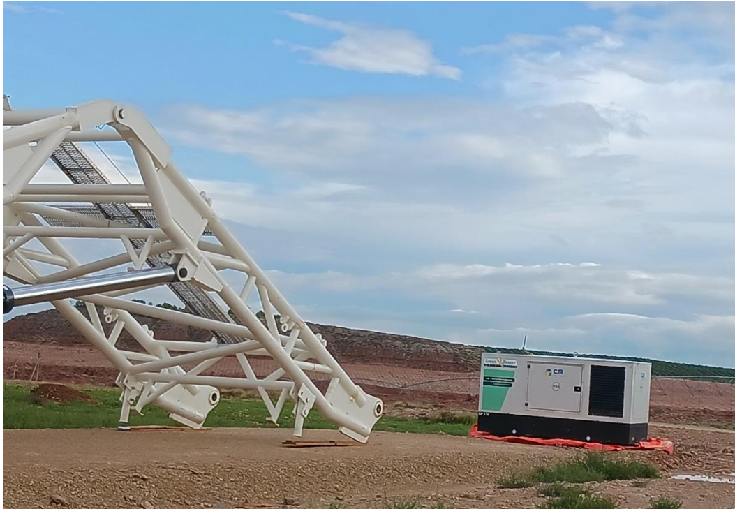
Figura 1: Grupo electrógeno sobre plástico protector para evitar posibles derrames de combustible.
