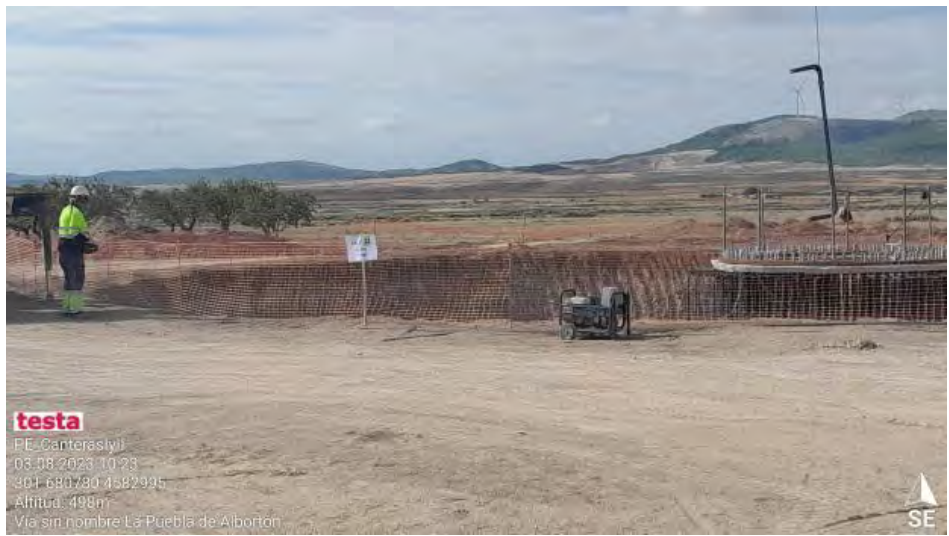
Generador sin bandeja de protección en CNTII-12.
