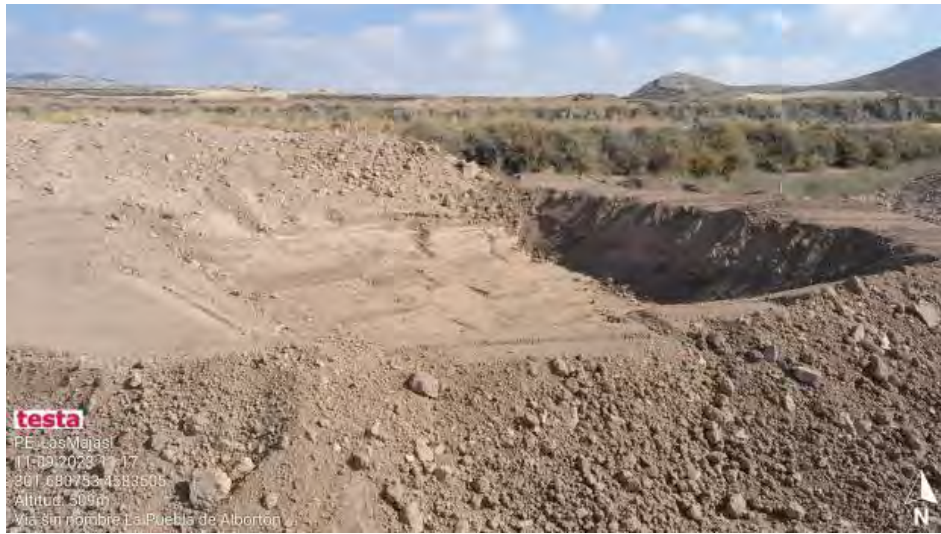
Nuevo pozo de Lavado en CNII-12
