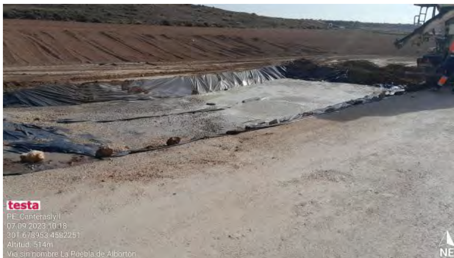
Pozo de Lavado en CNII-8
