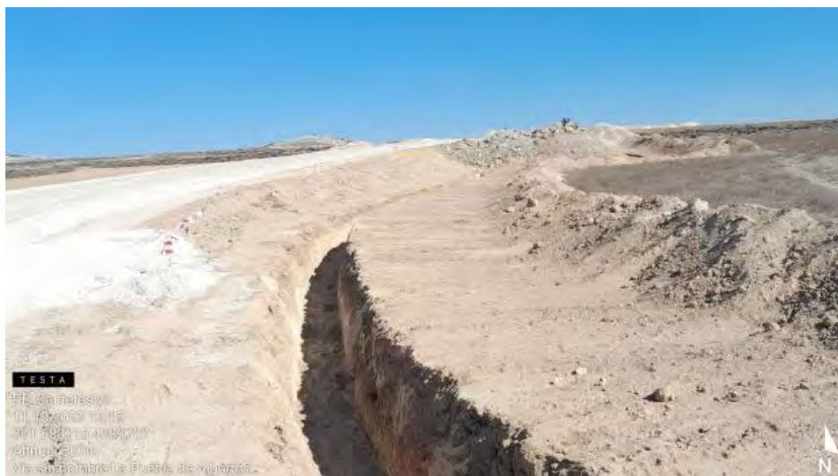
Acopio de tierras incorrecto
