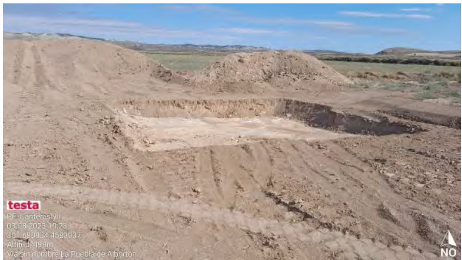
Ubicación de pozo de lavado en CNTII-13
