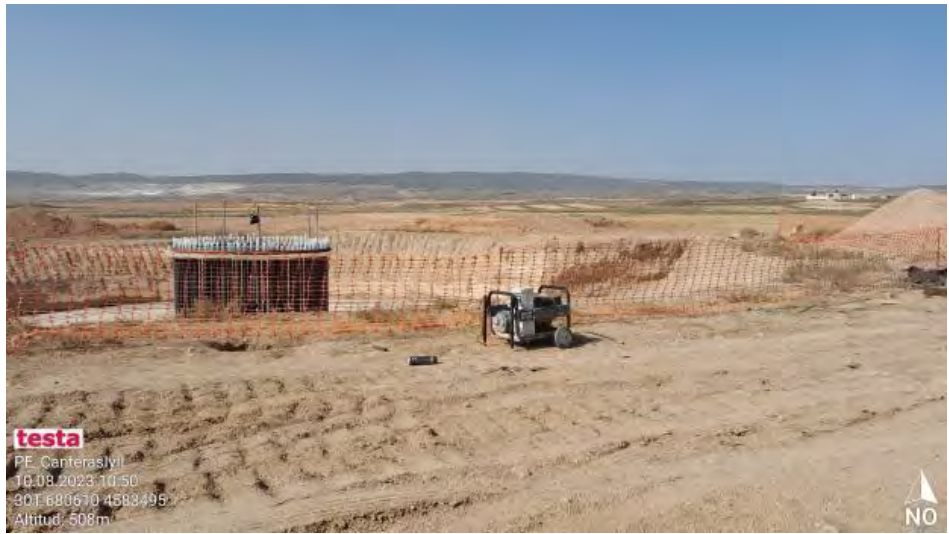
Generador sin bandeja de protección en CNTII-7
