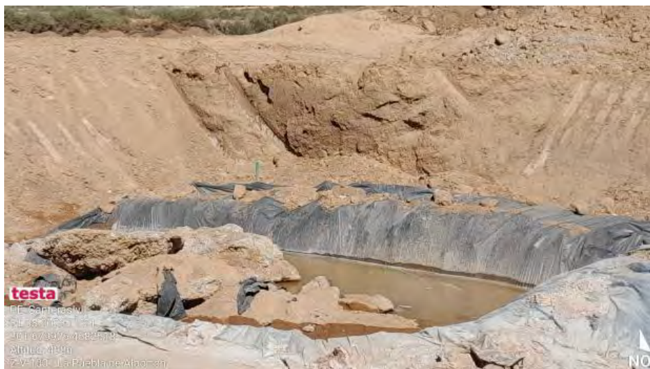
Pozo de Lavado en CNII-9
