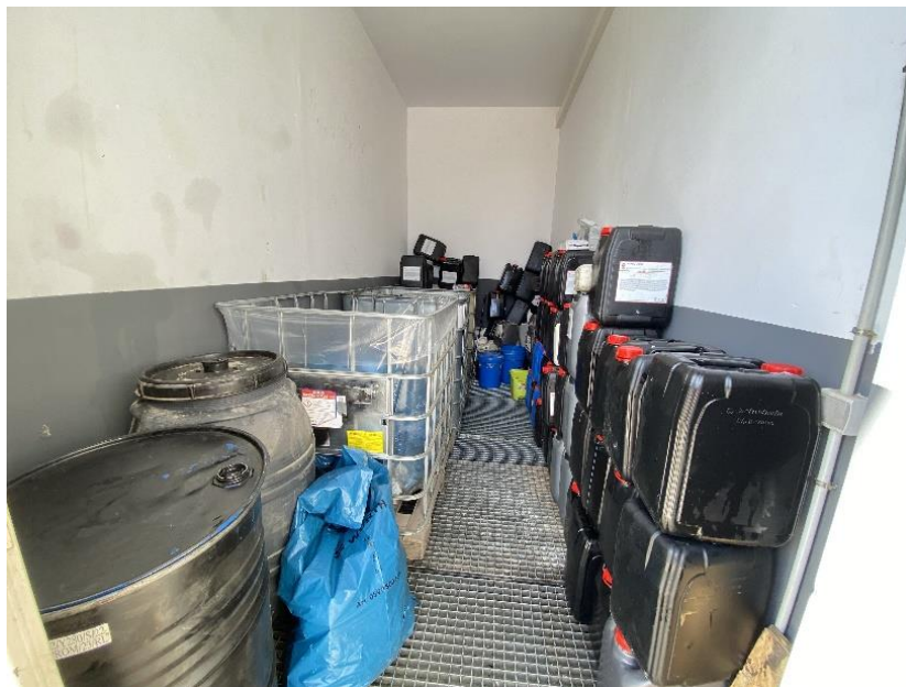
Figura 12: Interior del almacén de residuos de la SET “Campo de Magallón”, con los diferentes residuos peligrosos clasificados, aislados de la intemperie y sobre una tarima aislante para evitar posibles filtraciones al suelo.
