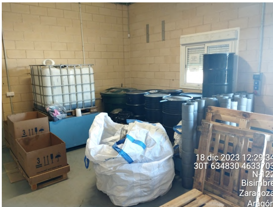
Figura 42: Interior del almacén de residuos de la SET “Valcardera”, con los diferentes residuos peligrosos aislados de la intemperie y sobre una tarima aislante para evitar posibles filtraciones al suelo.
