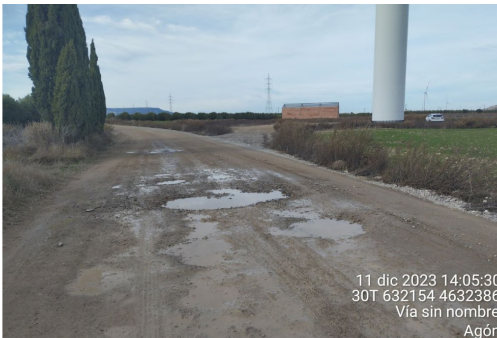
Figura 35: Vial de acceso a plataforma de AG-03. Obsérvese el tramo de vial que está deteriorado tanto por la erosión natural como por el tráfico rodado.
