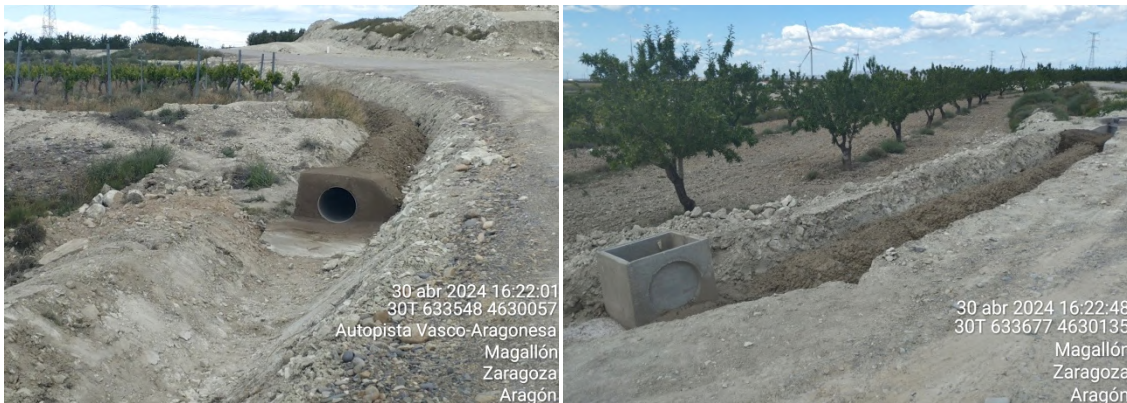
Tubos enterrados de PVC aledaños a los viales para la reconducción de algunos canales de agua preexistentes de acequias agrícolas.
