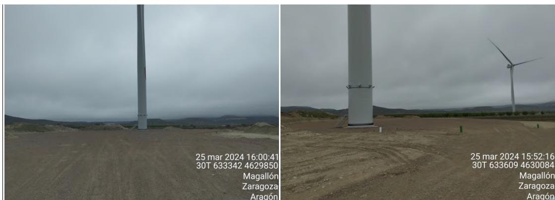
Plataformas de AGB-1 y AGB-2 aún pendientes de restauración de sus áreas colindantes empleadas por la maquinaria de izaje de los aerogeneradores.
