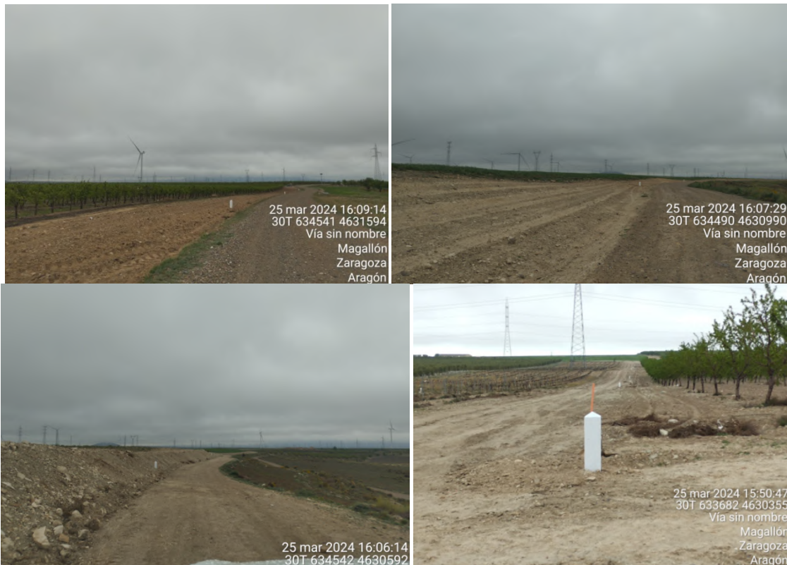
Tramos soterrados de la evacuación del PE, desde su tramo más norte hasta el sur al llegar a las plataformas de los aerogeneradores.
