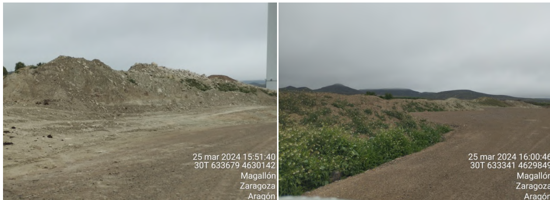
Acopios de tierras minerales y tierra vegetal ubicados en plataformas de aerogeneradores AGB2 (arriba) y AGB1 (Abajo).
