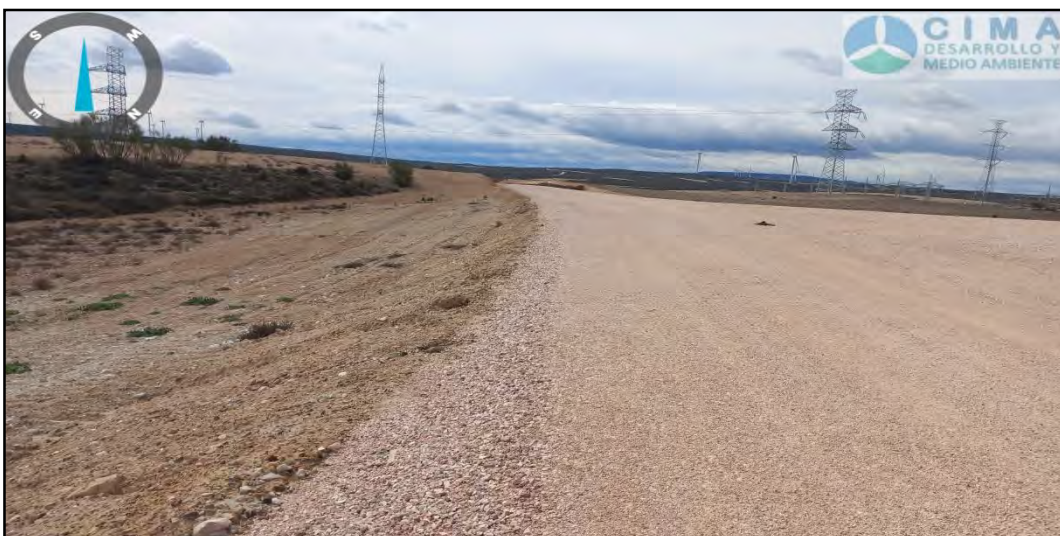
Fotografía 3. Vista general en la turbina ACS02.
