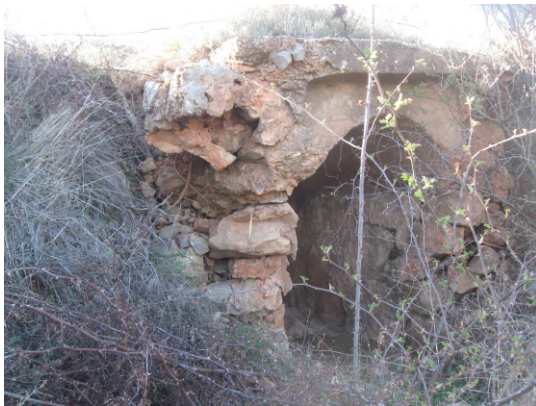
Salida de agua antes de la actuación.
