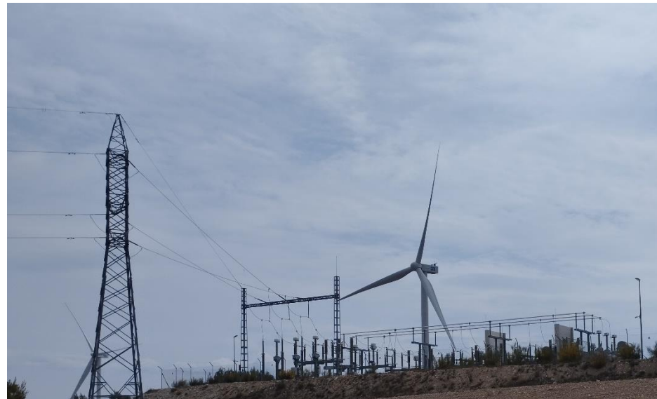
Fotografía 3: Subestación, línea eléctrica y parque eólico
