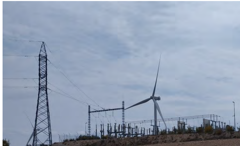
Fotografía 3: Subestación, línea eléctrica y parque eólico
