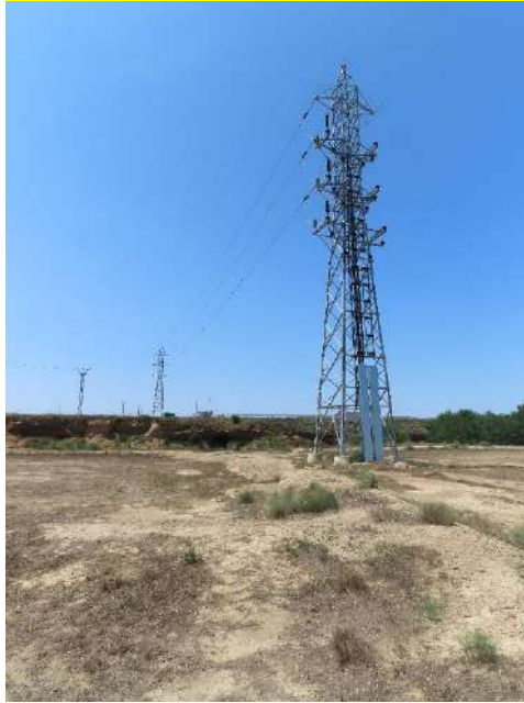
Figura 8: Entorno del apoyo 2 de la LAAT y cruce del Flumen a apoyo 1
