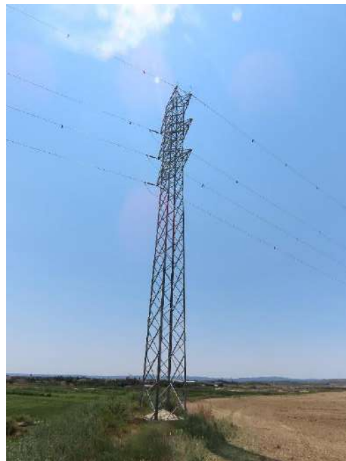
Figura 11: Vista del apoyo 11 de la LAAT
