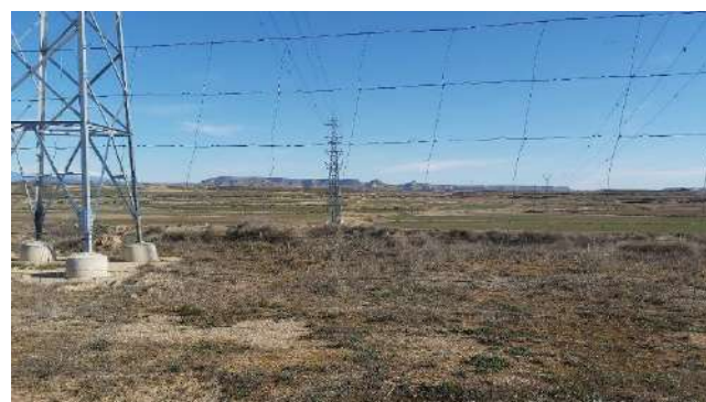
Figura 3: Apoyo 1 y 2 de la línea de evacuación
