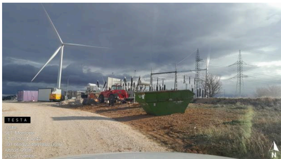
Contenedor cambiado en punto limpio de SET Monforte.
