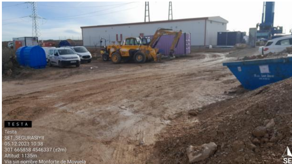
Limpieza de derrame da lavado de cubas en SET Seguras.
