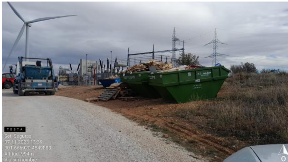
Punto limpio en SET Monforte
