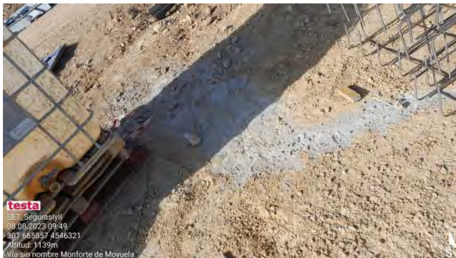
Derrames en SET Seguras.
