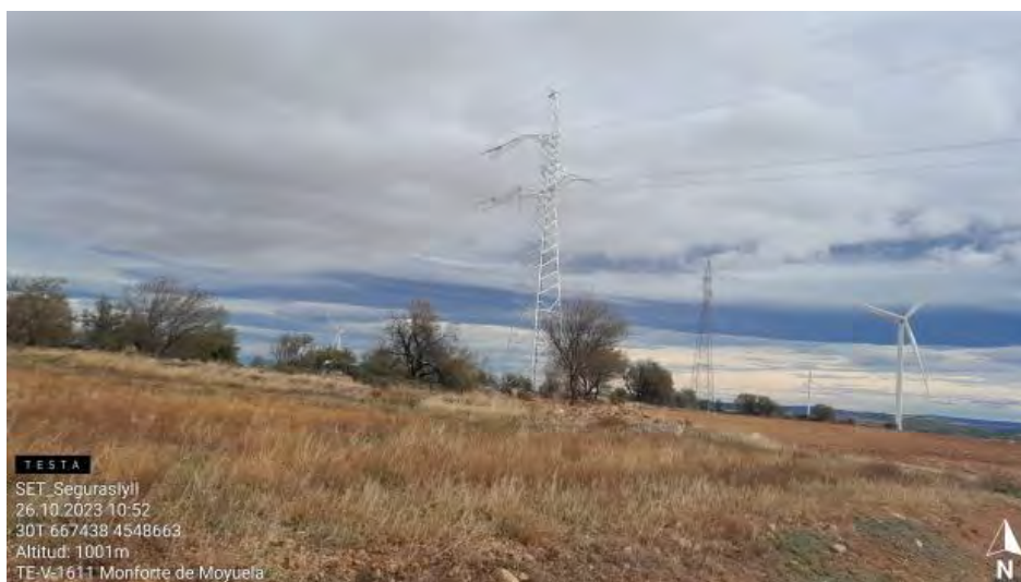
Cableado en LAT
