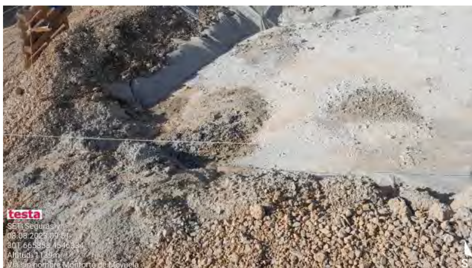
Pozo de lavado en SET Seguras.
