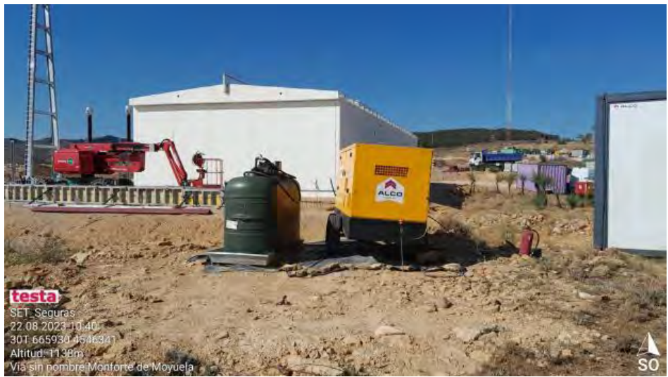
Colocación y situación inadecuada de generador y depósito en SET Seguras.
