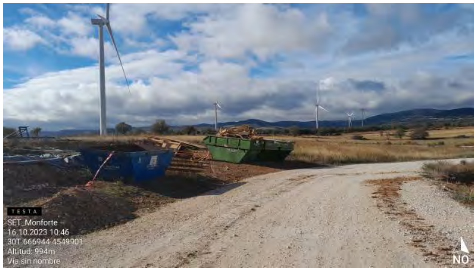
Vaciado y organización de contenedores de RNP insuficiente en SET Monforte.
