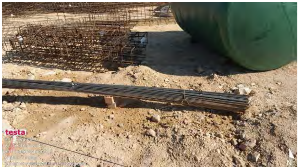
Derrame en punto limpio
