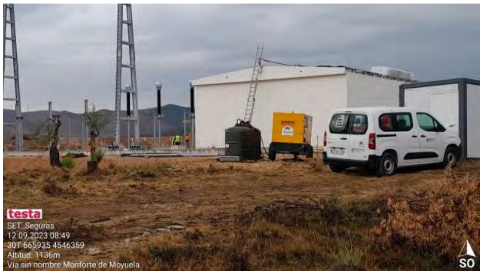
Generador más depósito de combustible.
