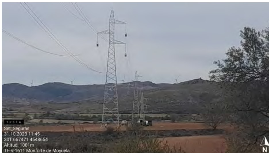
Cableado en LAT
