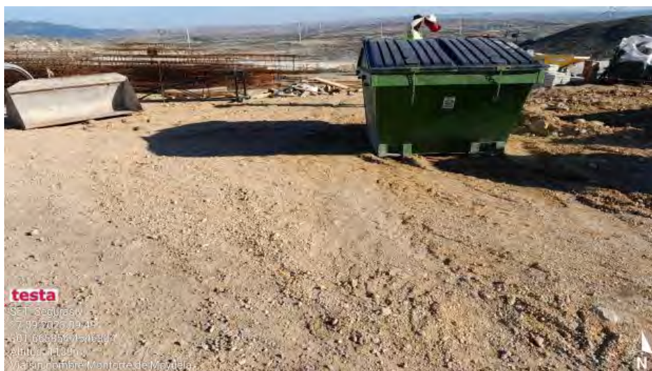
Limpieza de derrames en SET Seguras.
