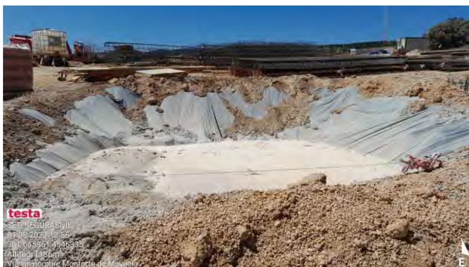
Pozo de lavado en SET Seguras.
