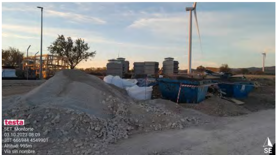
Contenedores de RNP llenos en SET Monforte.
