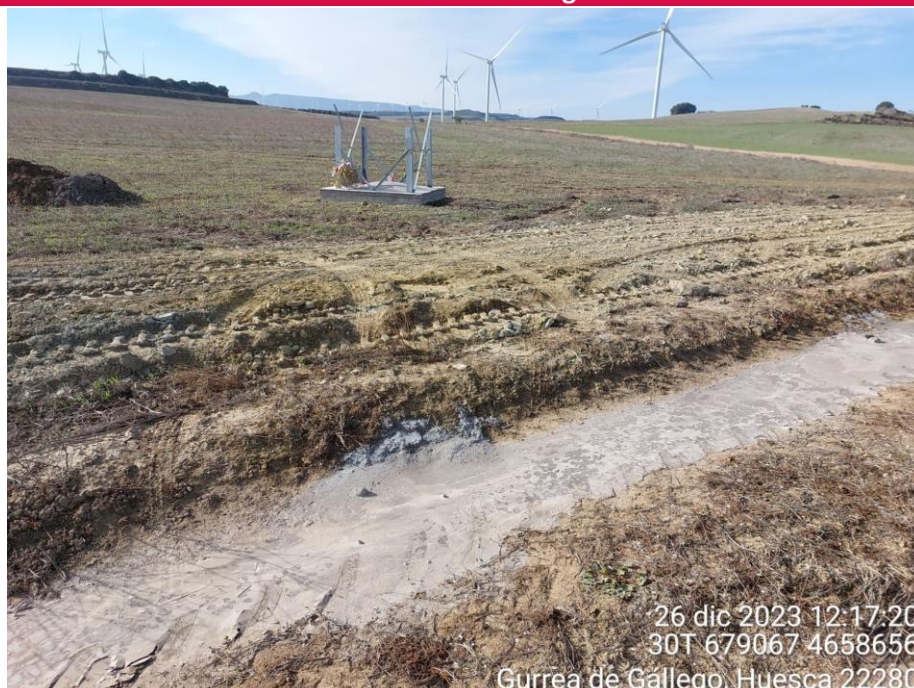
Ilustración 1. No conformidad leve. Manchas de hormigón en el apoya 27.
