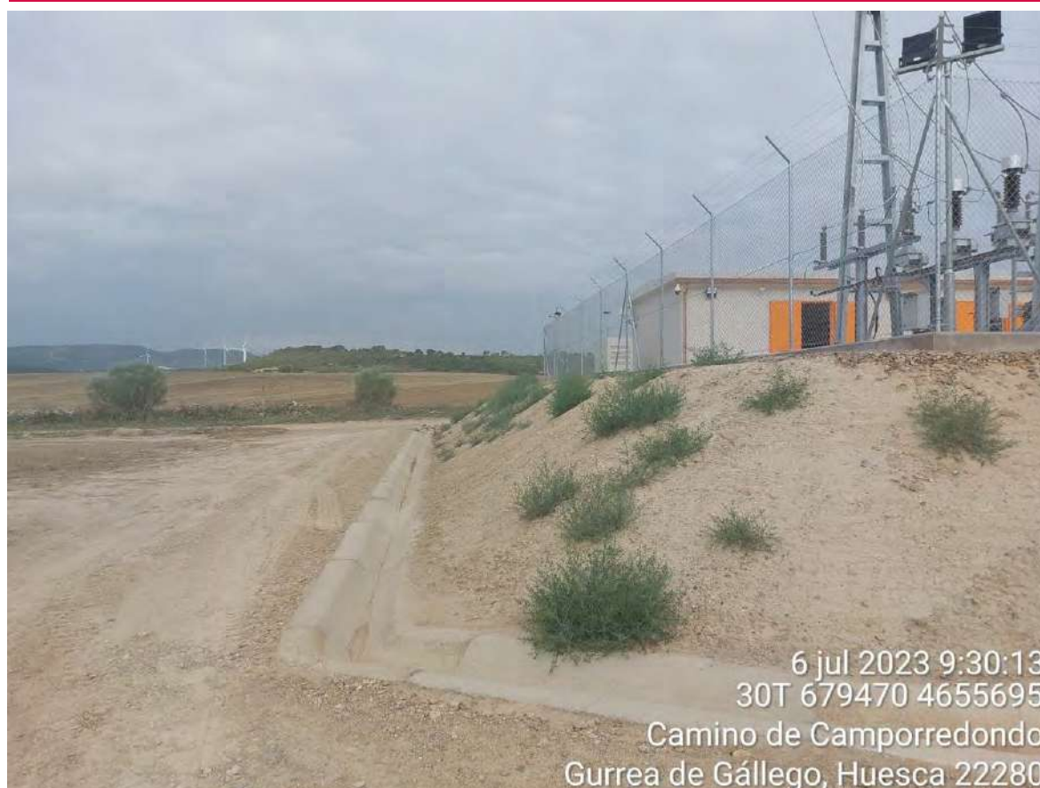
Imagen 1. Talud de la SET que se deberá tratar con hidrosiembra sobre malla.
