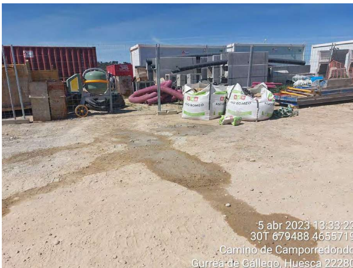
Imagen 1. Situación del punto limpio de TECINSA con mancha de hormigón en el suelo.
