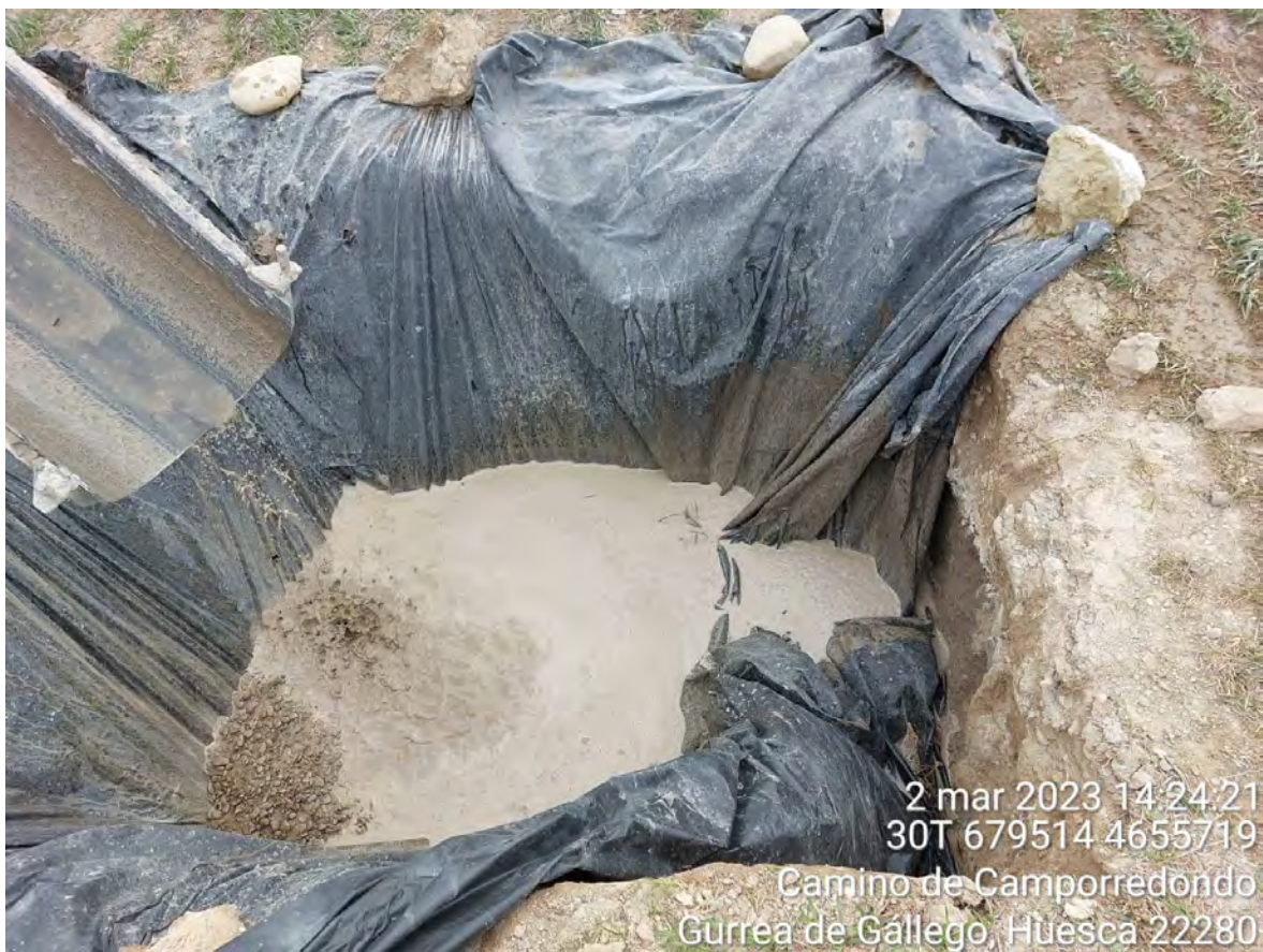
Imagen 2. Pozo de lavado en mal estado debido al levantamiento del plástico consecuencia del aire.
