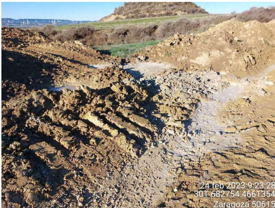
Imagen 2. Residuo de hormigón en la zona de la TM de OBIII próximo al cordón de tierra vegetal. Igualmente, se tiene que limpiar y gestionar correctamente para poder cerrar la NC.
