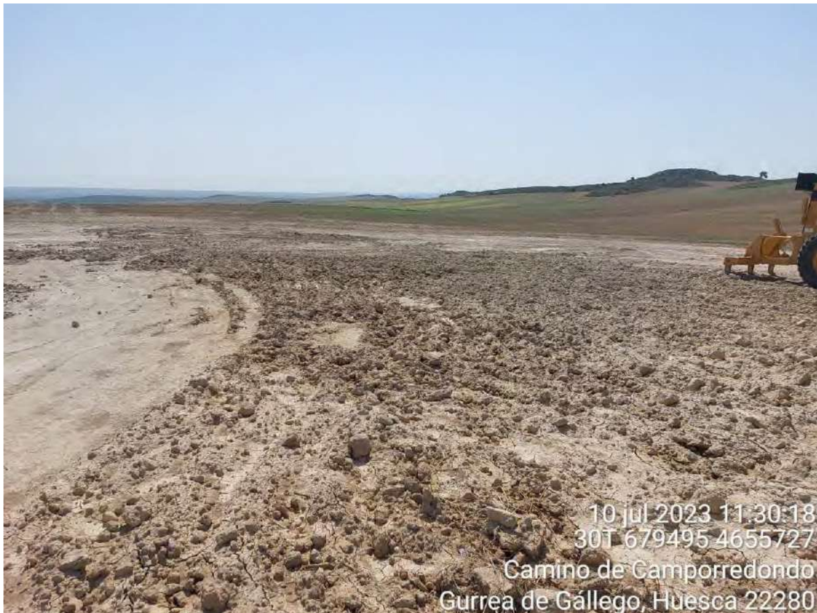
Imagen 1. Zona de la SET en la que se encontraba el material de excavación y el pozo de lavado.
