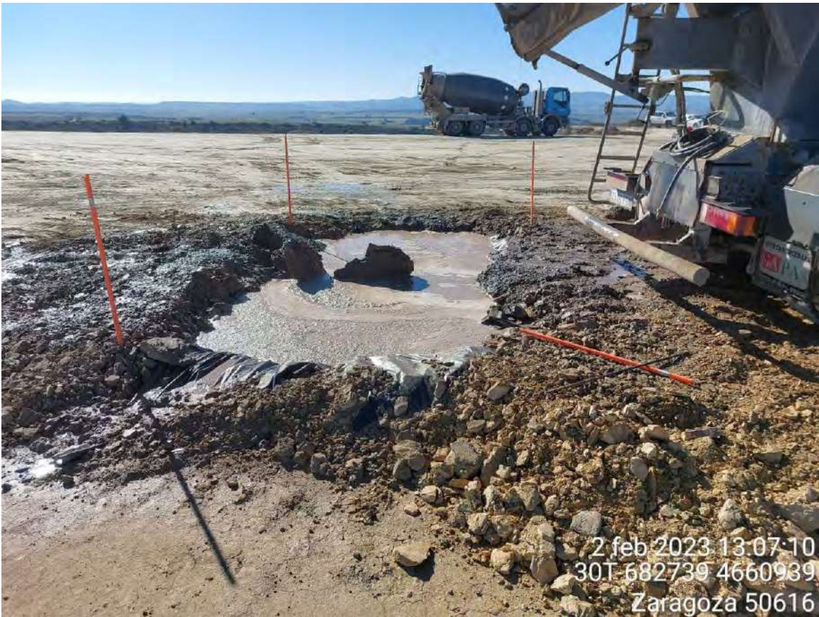
Imagen 2. Pozo de lavado colmatado durante el hormigonado de OBIII-02. COLLOSA gestiona el vaciado parcial del pozo mediante absorción. Al terminar el hormigonado se pasará maquinaria para retirar el hormigón de la plataforma y gestionarlo como tal.
