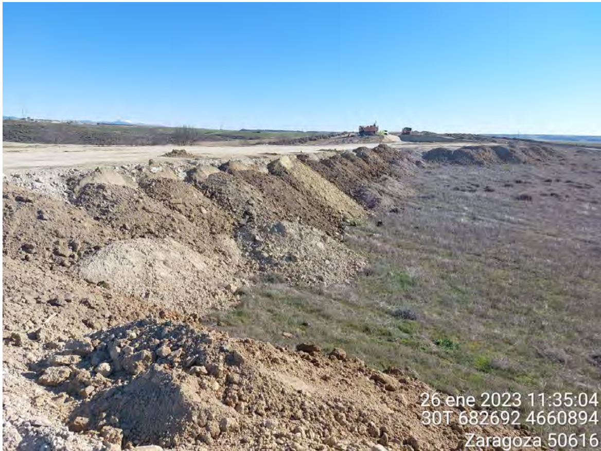
Imagen 2. Tierra vegetal acopiada en OBIII-02 que será utilizada para la restauración de ese talud.
