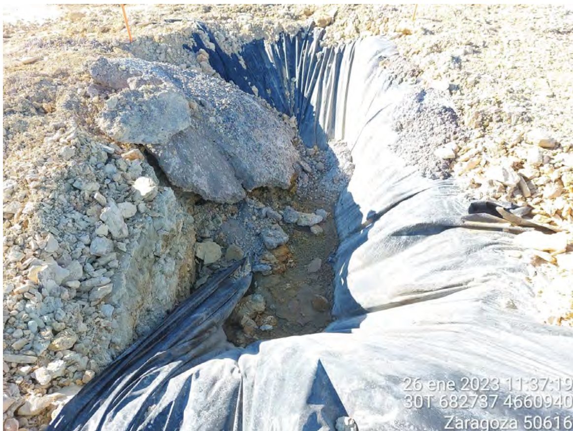
Imagen 4. Pozo de lavado utilizado en OBIII-02. Se recuerda que el suelo debe estar protegido lo máximo posible ante el hormigón. Al finalizar su uso ese hormigón se picará y se gestionará correctamente, restaurando la zona en la que se creó ese pozo.
