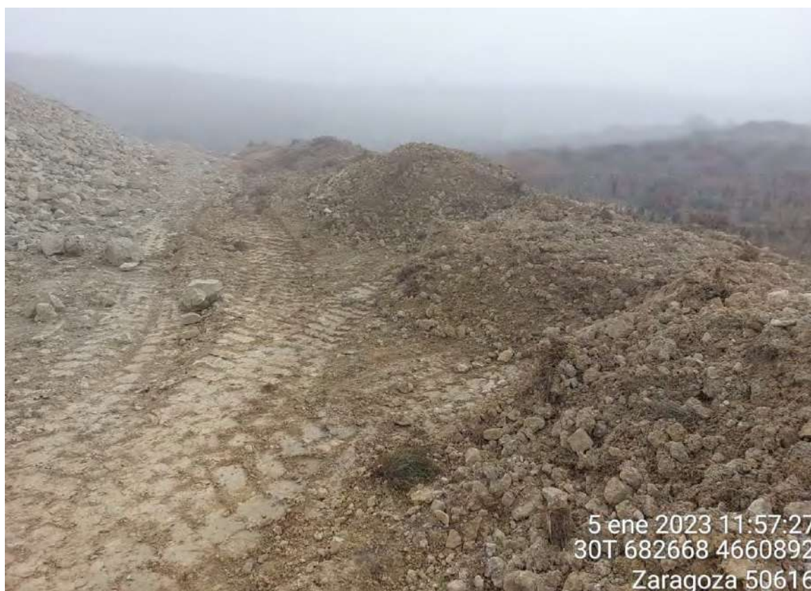
Imagen 1. No conformidad leve. Incorrecta separación de la tierra vegetal del resto del material extraído en OBIII-02.
