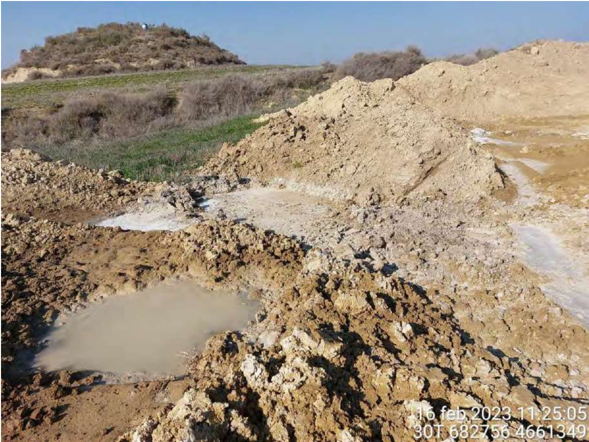
Imagen 2. Manchas de agua con hormigón en la zona de la TM de OBIII próxima a los cordones de tierra vegetal.
