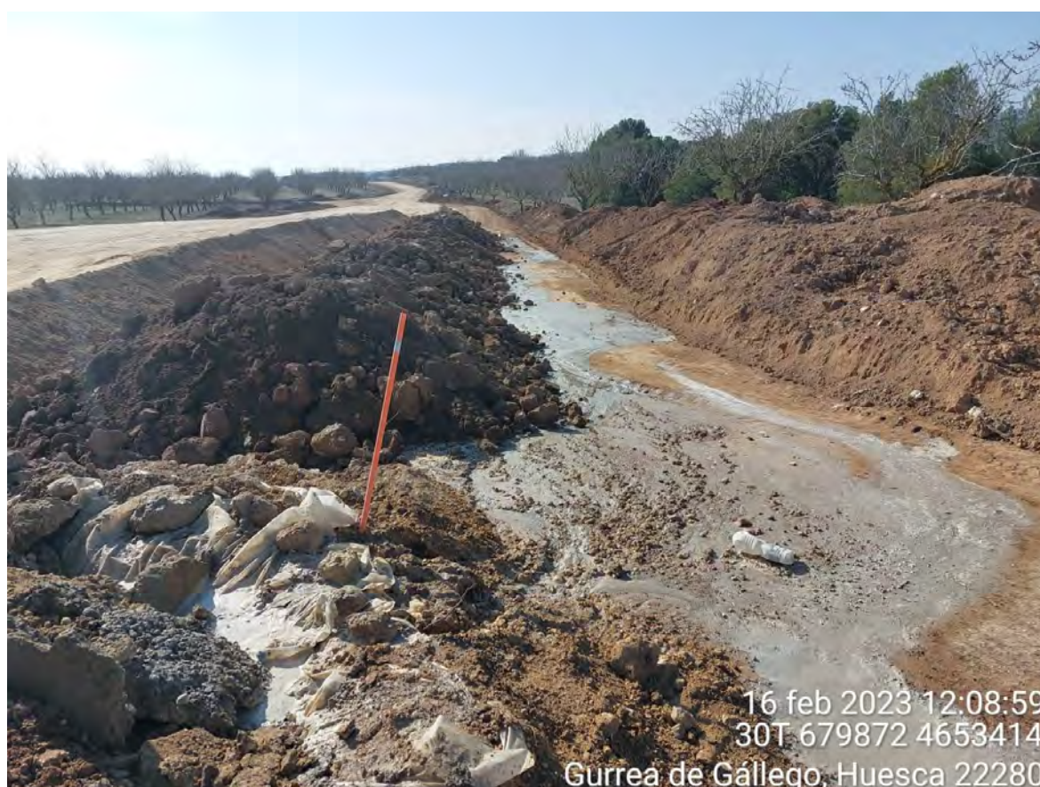
Imagen 1. Tierra contaminada por residuo de agua con hormigón debido a la colmatación del pozo de lavado.
