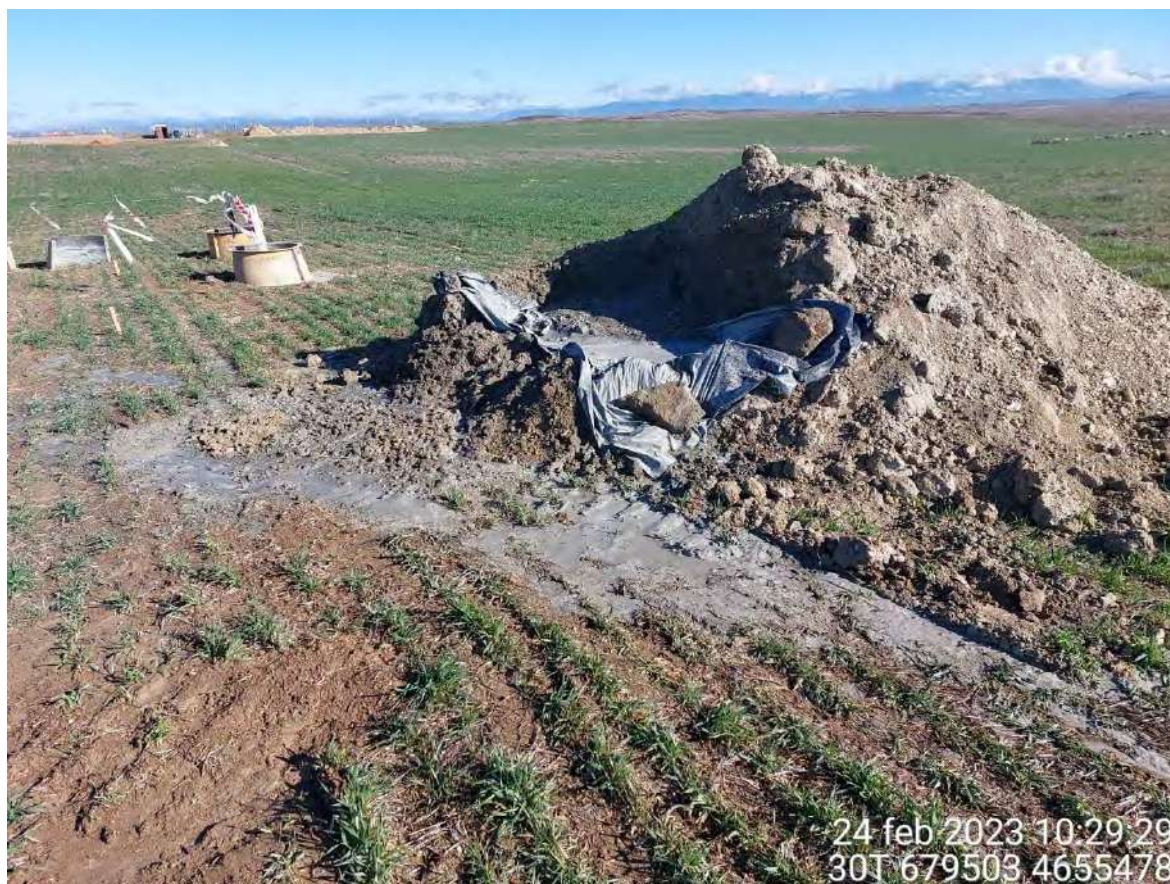
Imagen 3. Residuo de hormigón en el apoyo 39. Se debe recoger y gestionar como tal para no abrir una NC.
