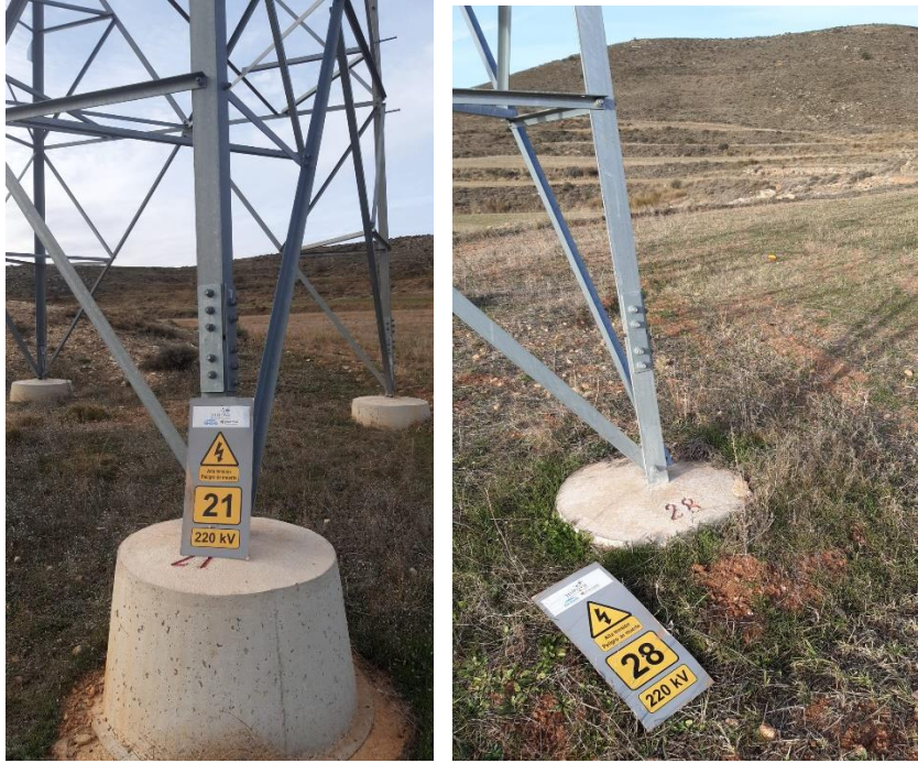
Fig 1 y 2. Cartel caído de los apoyos 21 y 28.
