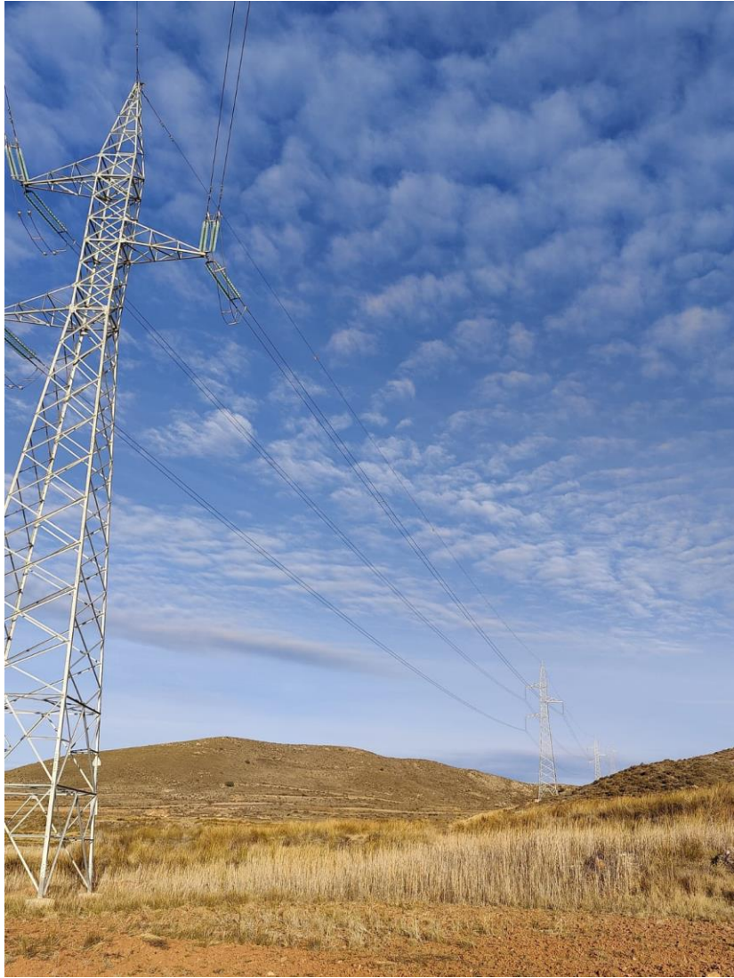
Fig 4. Tramo LAAT 30 - 29 En el que se observan como faltan balizas.
