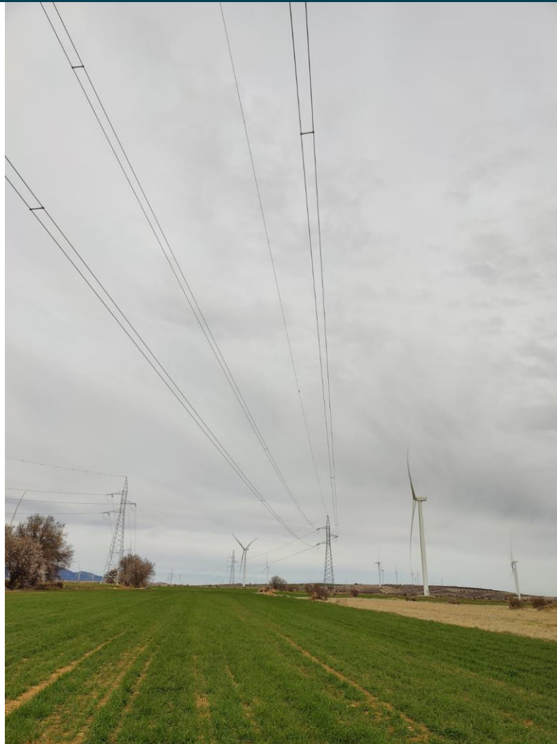
Fig 5. Tramo LAAT 06 - 05 En el que se observan como faltan balizas.
