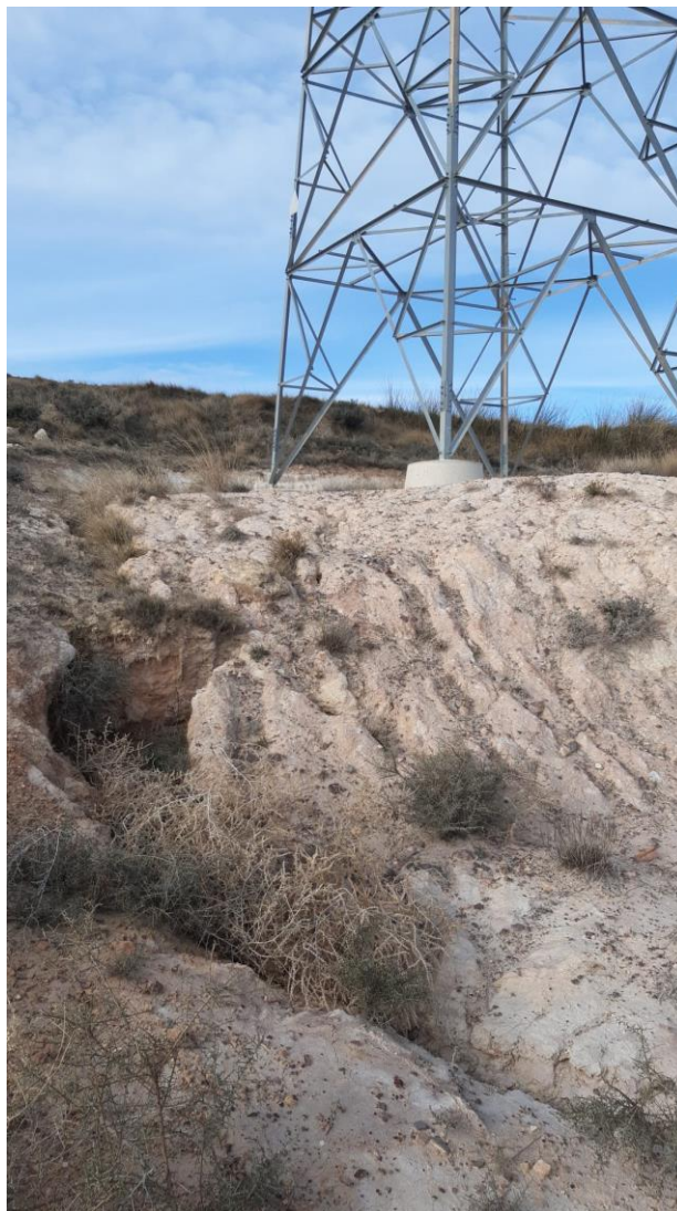
Fig 3. Erosión en el apoyo 20.
