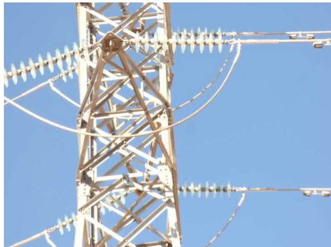
Imagen 2. Estado de conservación de los aisladores colocados en uno de los apoyos de la LAAT
