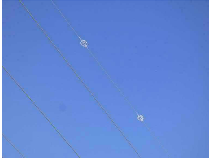
Imagen 3. Las balizas de tipo espiral debido a la radiación solar han perdido la coloración naranja, la cual no afecta a su funcionalidad
