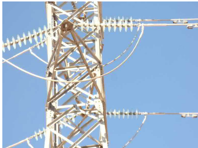
Imagen 2. Estado de conservación de los aisladores colocados en uno de los apoyos de la LAAT
