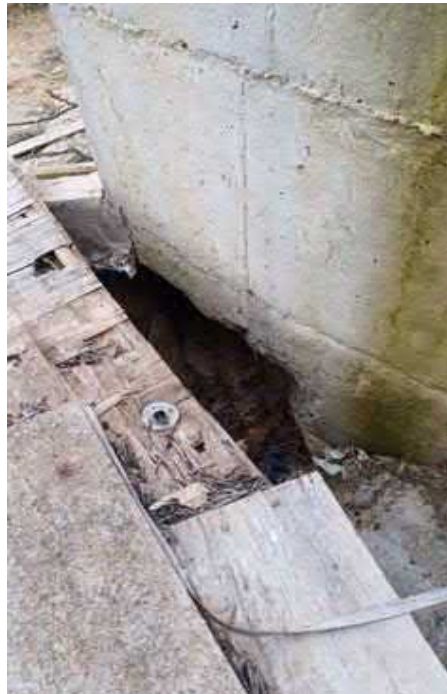
Imagen 11. Excavación realizada bajo el apoyo AP 65 para instalar la tubería de riego
