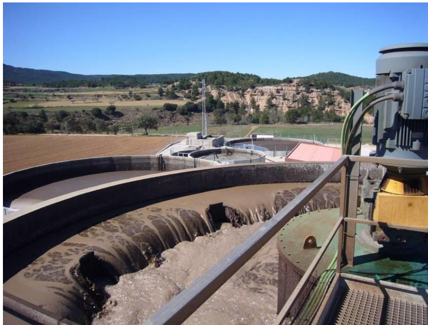
Figura 43. Imagen de un reactor de aireación en un proceso de nitrificación-desnitrificación.
