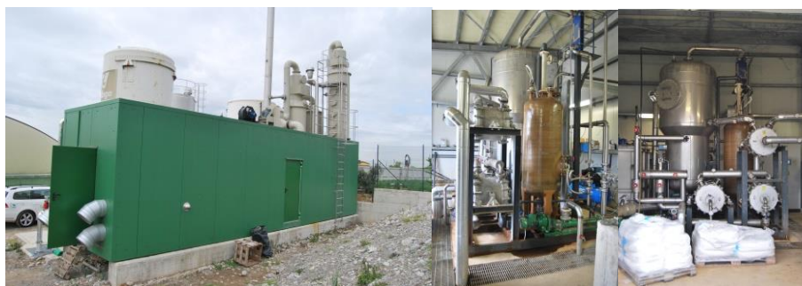
Figura 52. Imágenes de instalaciones de stripping de amoníaco en Italia.
