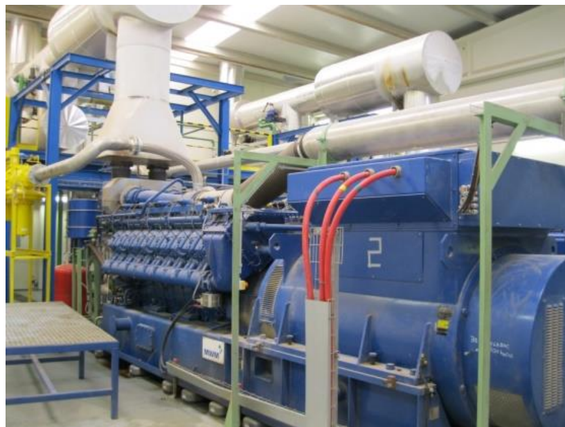
Figura 38. Unidad de cogeneración instalada en una planta de codigestión anaerobia con purín de vacuno.
