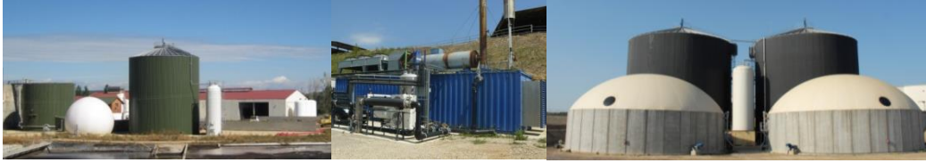
Figura 39. Plantas de biogás en Almazán (Soria) y Caparroso (Navarra) que operan con purín.
