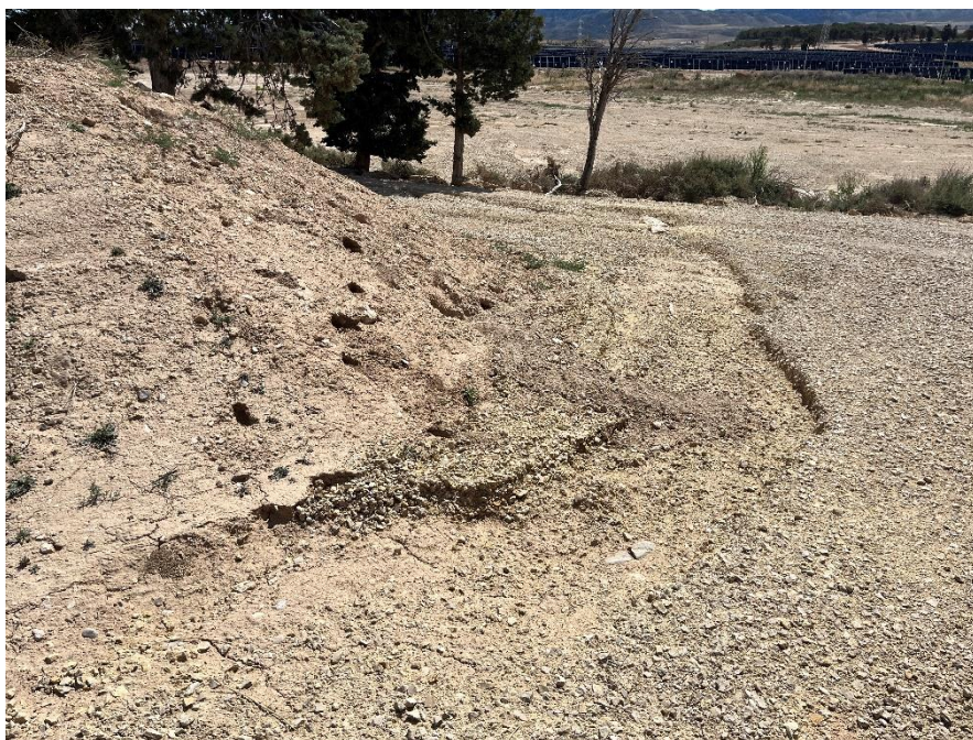
Figura 3 Erosión del vial
