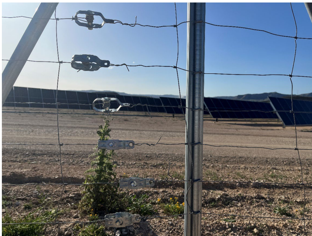
Figura 3 Elementos punzantes del vallado perimetral
