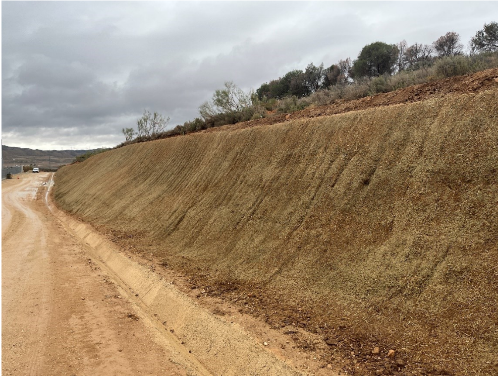
Figura 7 Colocación de malla de fibra de coco en el talud de la SET
