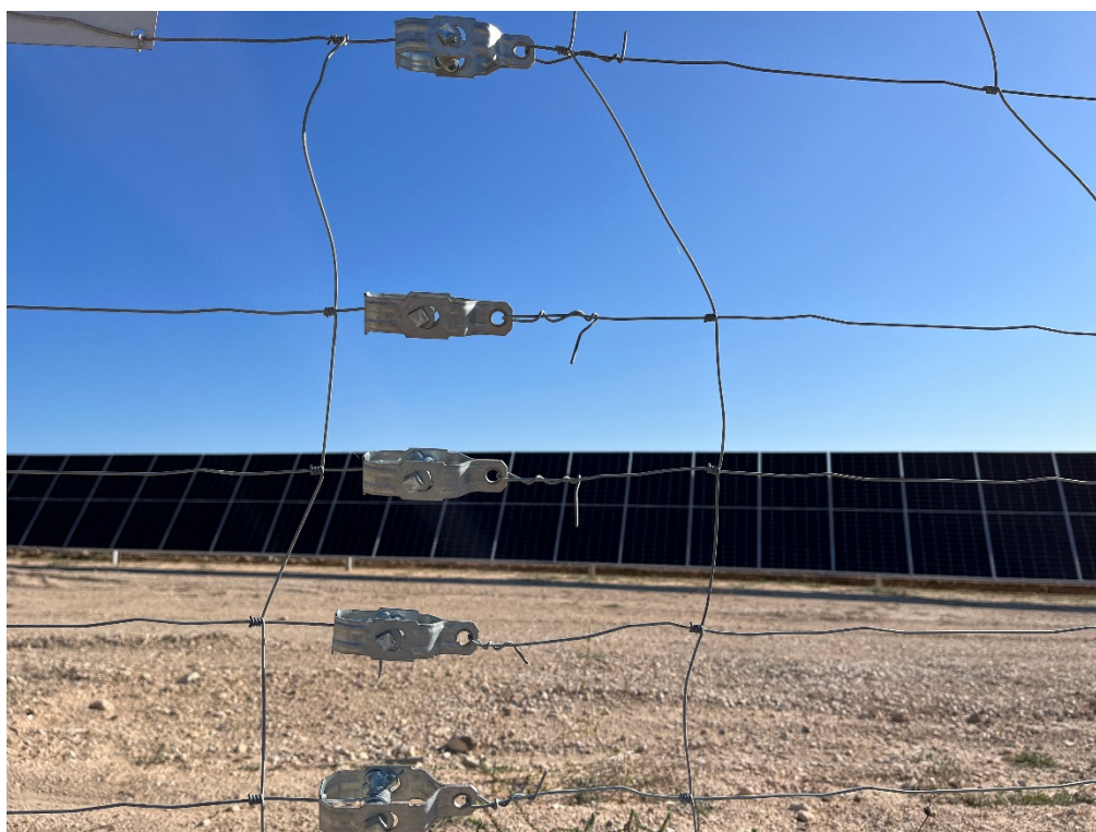
Figura 5 Elementos punzantes en el vallado perimetral
