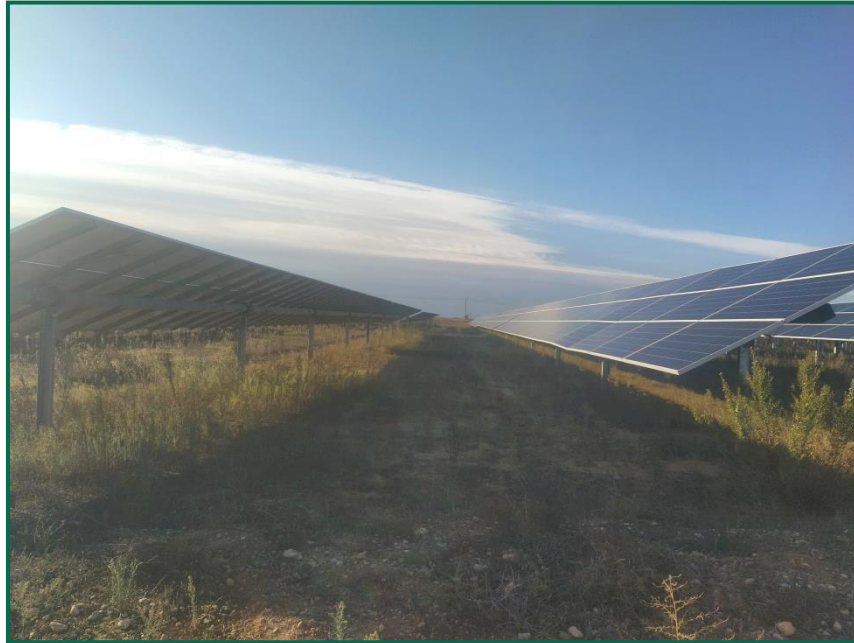
Fotografía 1. Vegetación entre placas en su estado actual.
