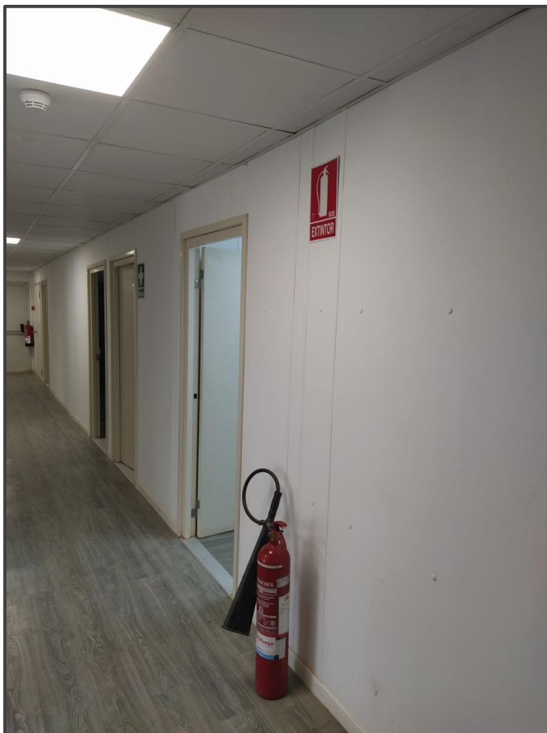
Fotografía 16. Extintores en edificio de control.
