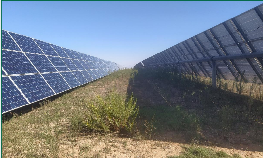
Fotografía 1. Vegetación entre placas en su estado actual.
