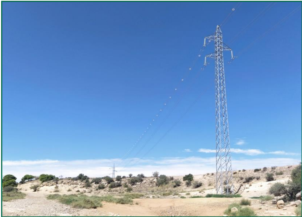
Fotografía 2. Línea eléctrica con balizas salvapájaros
