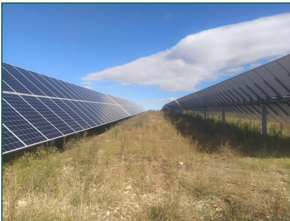
Fotografía 1. Vegetación entre placas actualmente.
