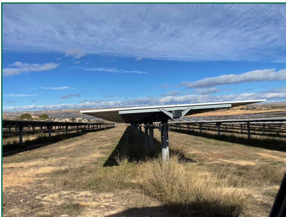
Fotografía 1. Vegetación entre placas actualmente.
