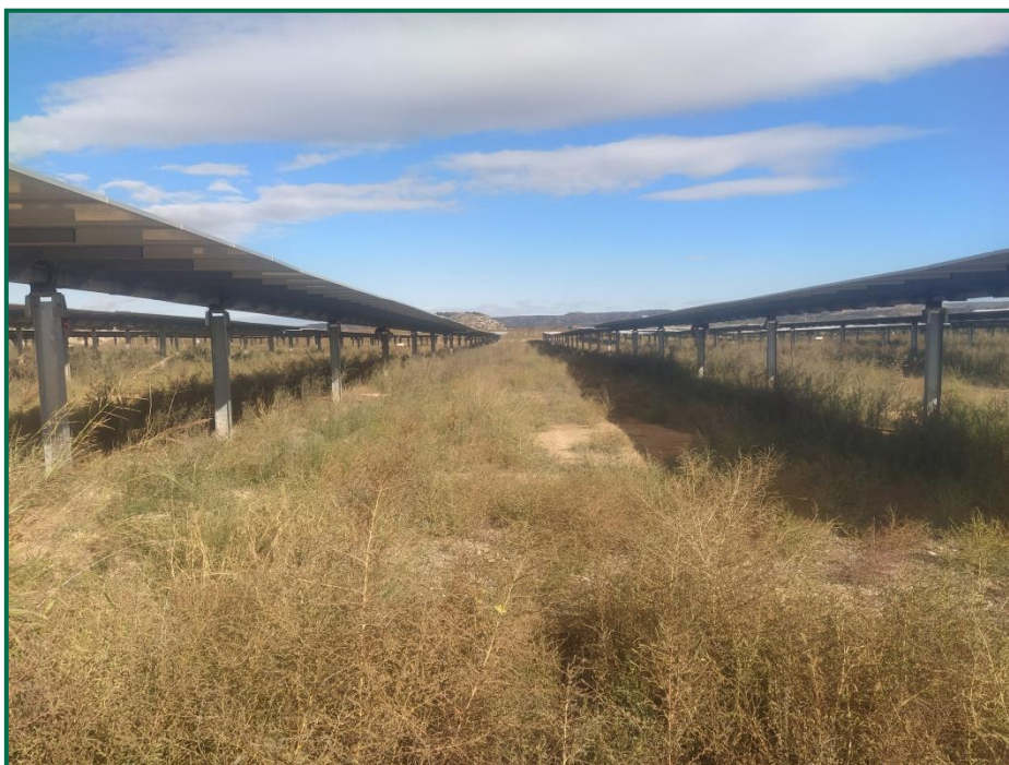
Fotografía 1. Vegetación entre placas actualmente.
