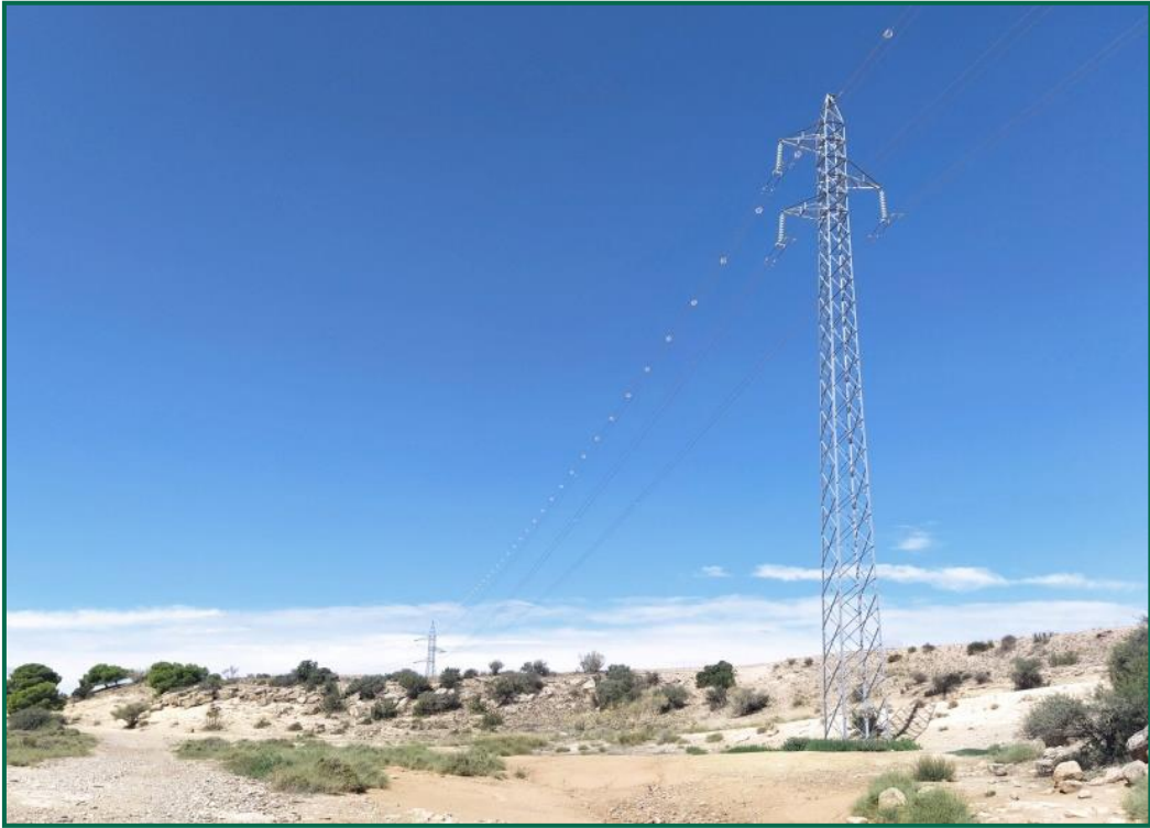
Fotografía 2. Línea eléctrica con balizas salvapájaros
