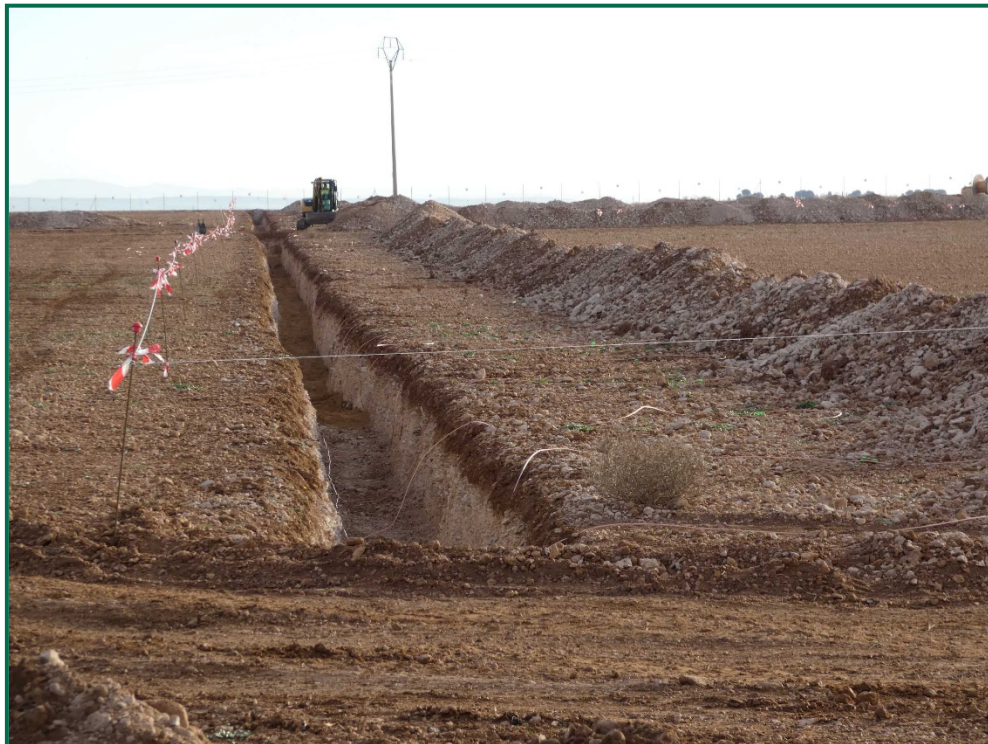
Fotografía 3. Acopios de tierra y zanjas.
