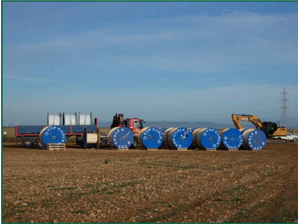
Fotografía 14. Bobinas de cable.
