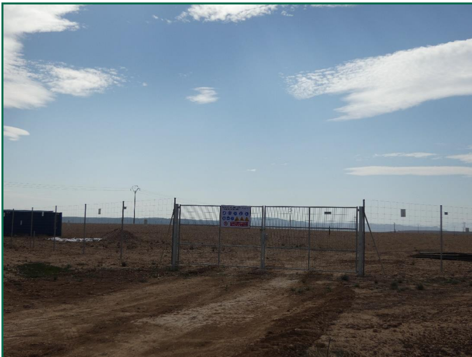
Fotografía 3. Vallado perimetral y placa anticolidión.
