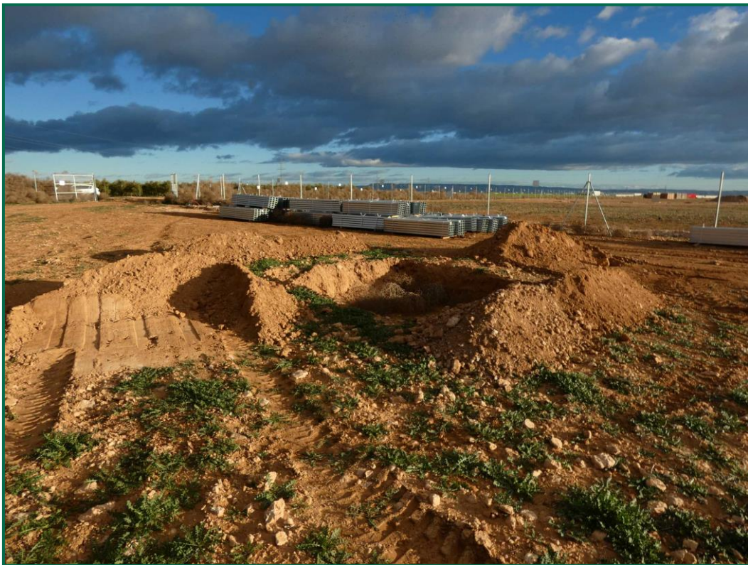
Fotografía 12. Balsa de limpieza.
