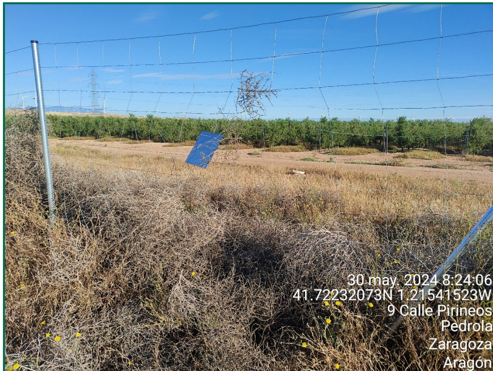
Fotografía 12. Destrozos en el vallado por robo.
