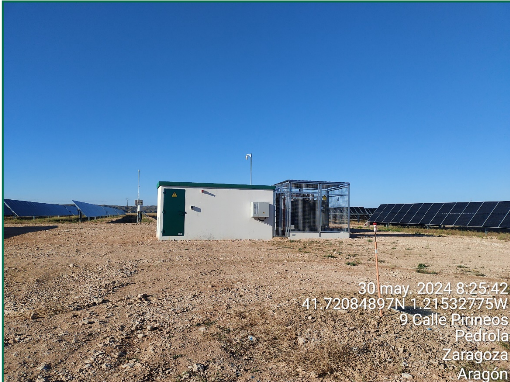
Fotografía 6. Estructura del CT.
