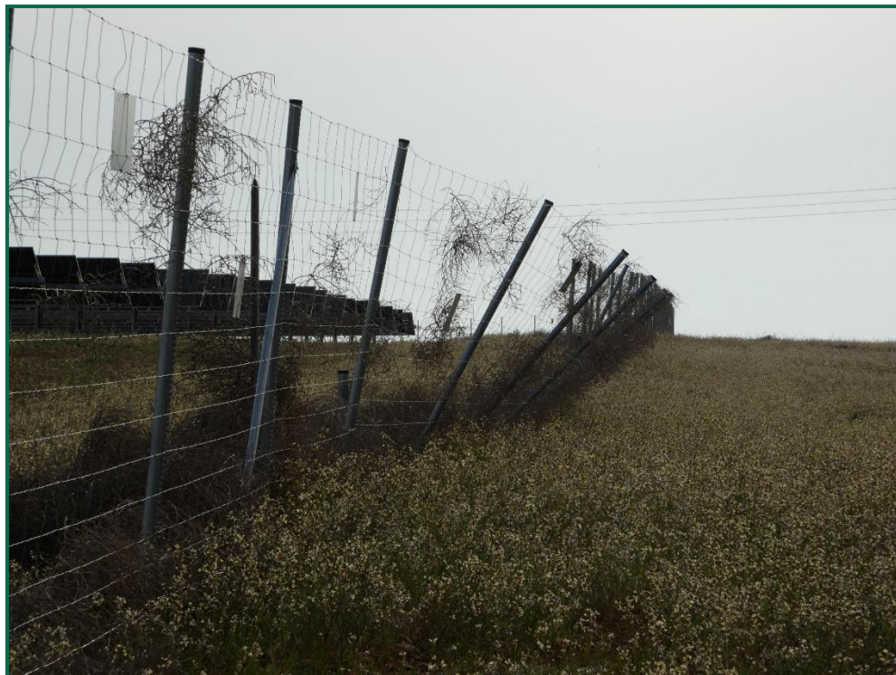
Fotografía 9. Vallado doblado por la acción del viento.
