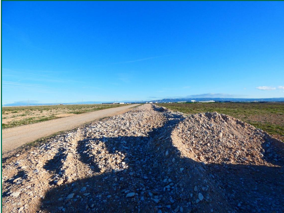
Fotografía 8. Línea de evacuación tapada.
