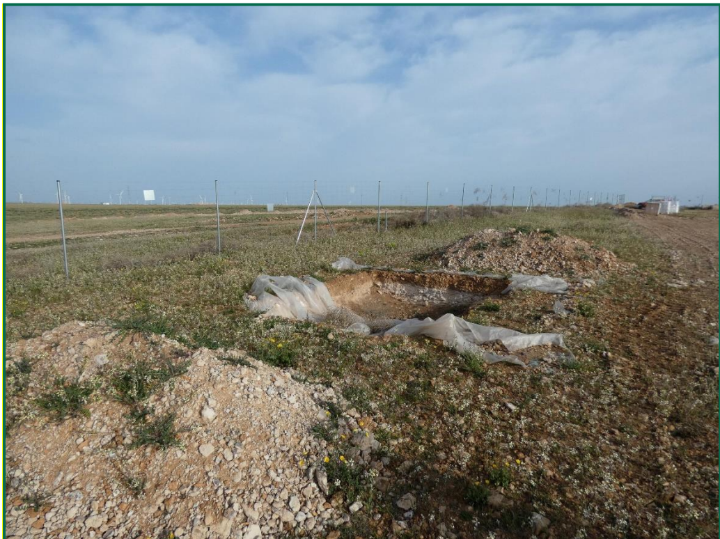
Fotografía 11. Balsa de limpieza.
