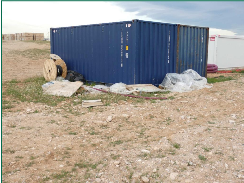
Fotografía 14. Restos de materiales utilizados.
