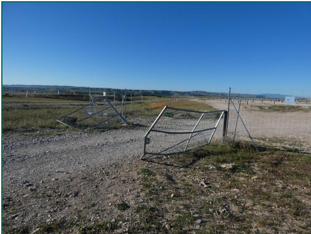
Fotografía 11. Puerta tumbada por los robos causados.
