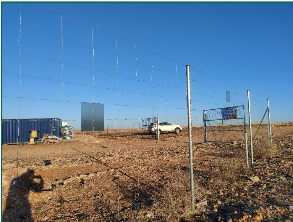
Fotografía 7. Vallado perimetral y placas anticolidión.
