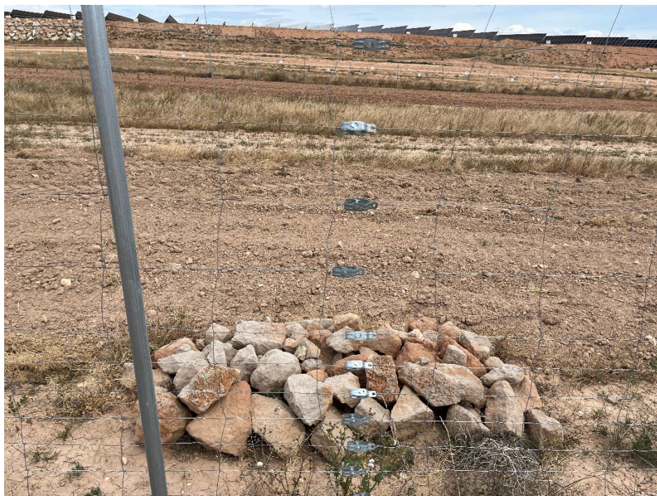
Figura 5 Vallado sin elementos punzantes
